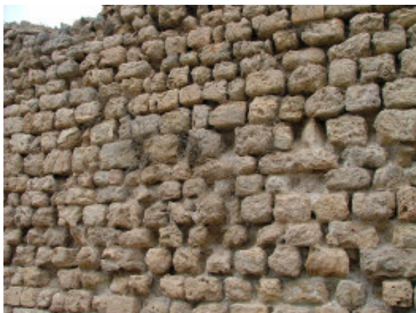
La pèrdua dels morters a causa de la reacció descrita en el text ha significat, en algun cas, la caiguda de carreus i la inestabilitat del mur afectat: l'exemple clar és aquest mur de les cavallerisses.
