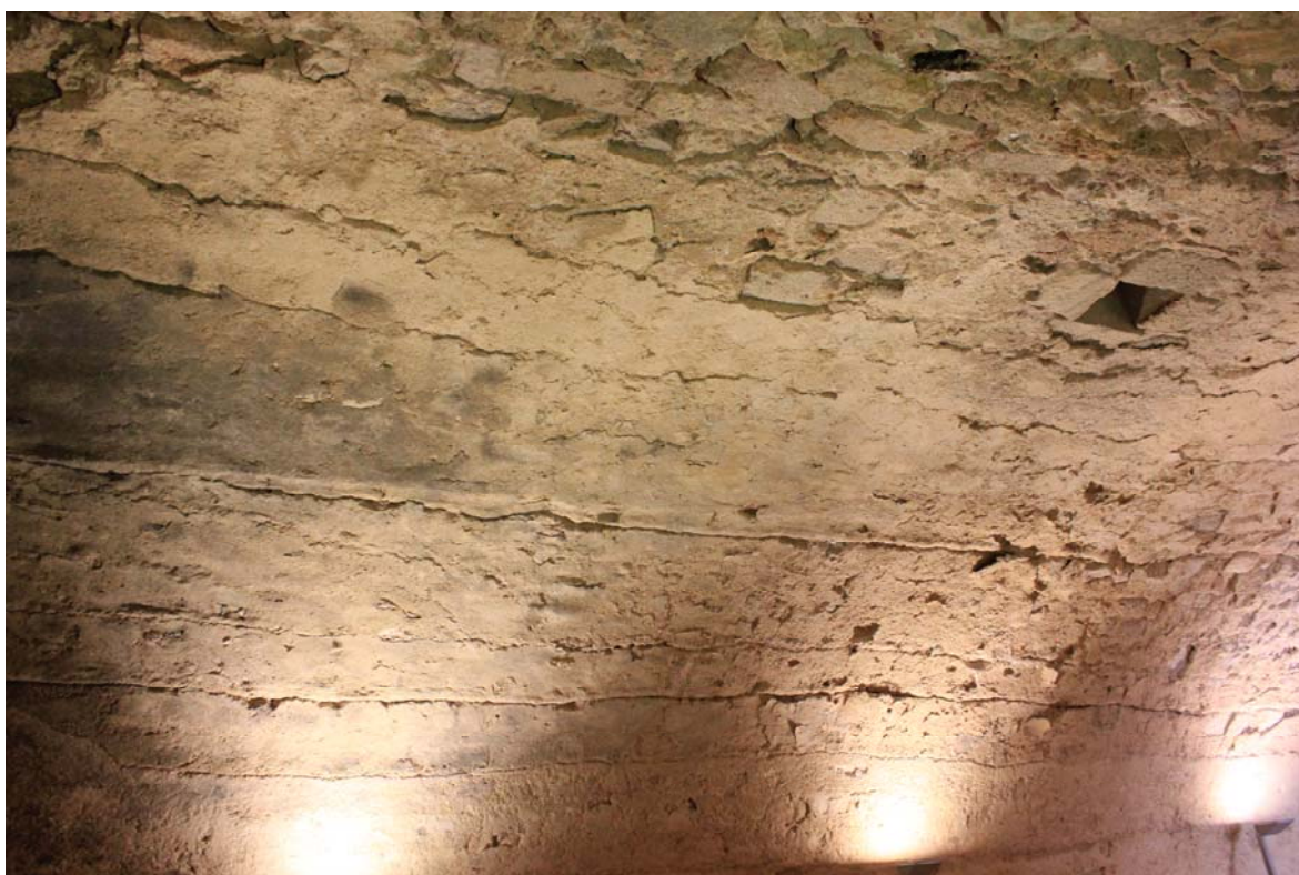
Fotografia 18. Detall de l'estat actual de conservació de les voltes amb plaques de morter amb estabilitat precària i degradacions considerables.
