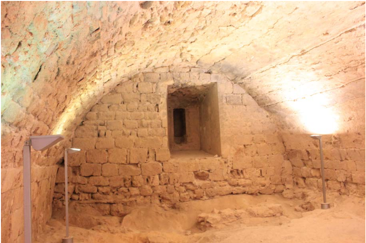
Fotografia 11. Detall de l'estat actual del tancament del cantó de ponent del celler.
