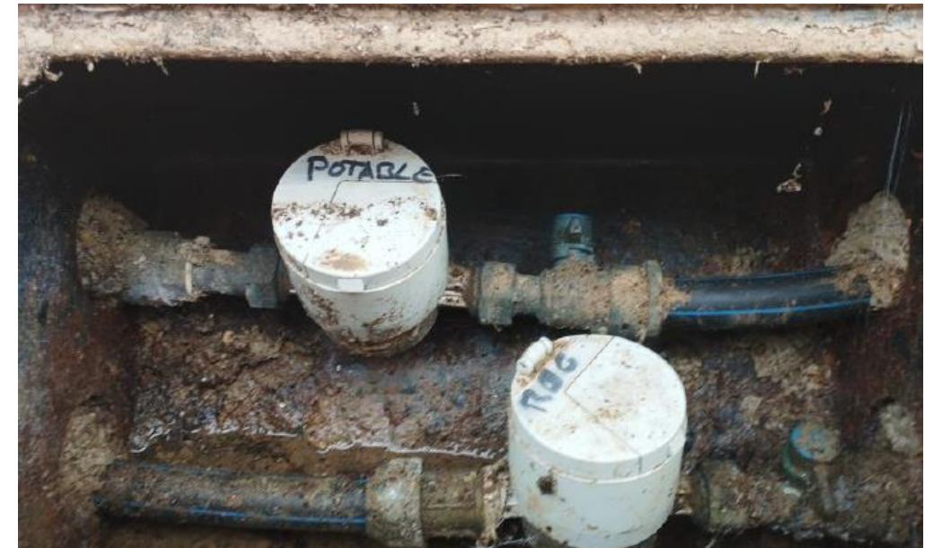
Figura 8. Vista interior armari amb les dues xarxes, aigua potable i reg
