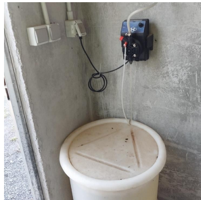
Figura 7. Vista interior caseta cloració dipòsit Nou (2)
