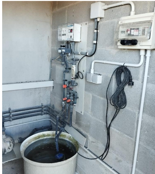
Figura 6. Vista interior caseta cloració dipòsit Nou
