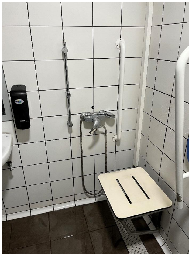
Dutxa adaptada del vestidor d'abonats piscina de la planta baixa
