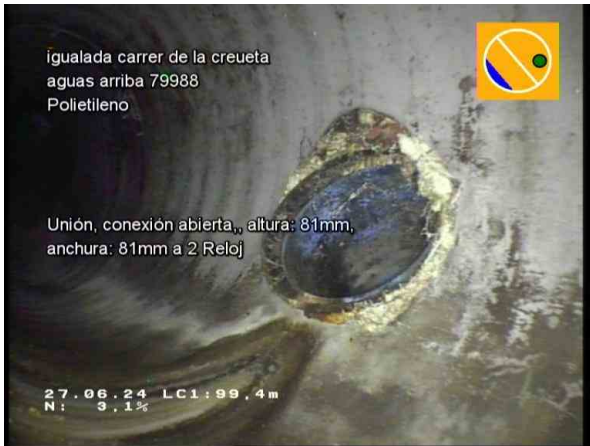
29763_95fb6feb-0f12-4188-aa30-883fe9c1fccf_20240627_095705_157.jpg, 00:26:30, 99.40m Unión, conexión abierta,, altura: 81mm, anchura: 81mm a 2 Reloj
