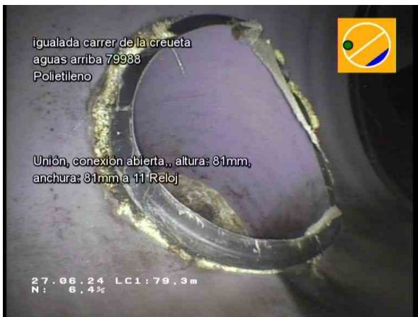
29763_ee850d57-1dc2-430a-8f25-61c1c40c18bc_20240627_094432_989.jpg, 00:19:28, 79.30m Unión, conexión abierta., altura: 81mm, anchura: 81mm a 11 Reloj
