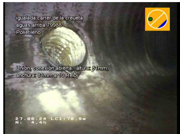
29763_1153f63a-b7e0-463d-847e-a6f1a2685edf_20240627_094040_642.jpg, 00:16:05, 70.90m Unión, conexión abierta., altura: 81mm, anchura: 81mm a 10 Reloj
