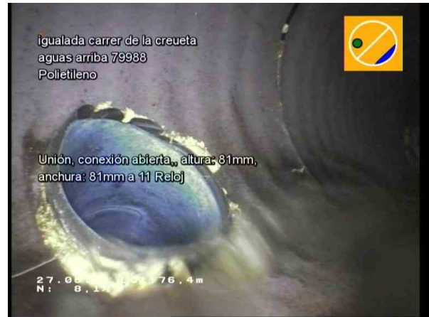
29763_841e43ce-175d-4719-9953-7ac635d65e60_20240627_094300_120.jpg, 00:18:04, 76.40m Unión, conexión abierta., altura: 81mm, anchura: 81mm a 11 Reloj
