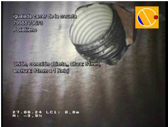
29764_47f944bf-330d-4782-b5ea-000810c1d7f9_20240627_101806_502.jpg, 00:00:20, 0.80m Unión, conexión abierta,, altura: 81mm, anchura: 81mm a 1 Reloj
