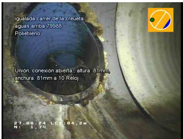
29763_0bedf952-b033-4c3a-9e26-cc66cb213a17_20240627_095031_386.jpg, 00:21:04, 84.20m Unión, conexión abierta., altura: 81mm, anchura: 81mm a 10 Reloj
