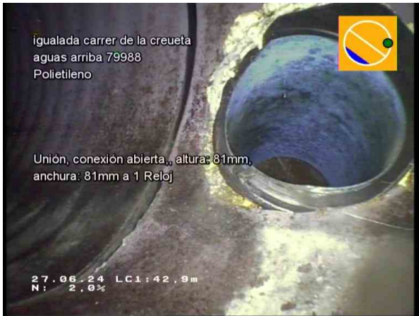
29763_4982af30-eb71-4177-9634-9d1f625d7d88_20240627_093242_303.jpg, 00:09:24, 42.90m Unión, conexión abierta., altura: 81mm, anchura: 81mm a 1 Reloj
