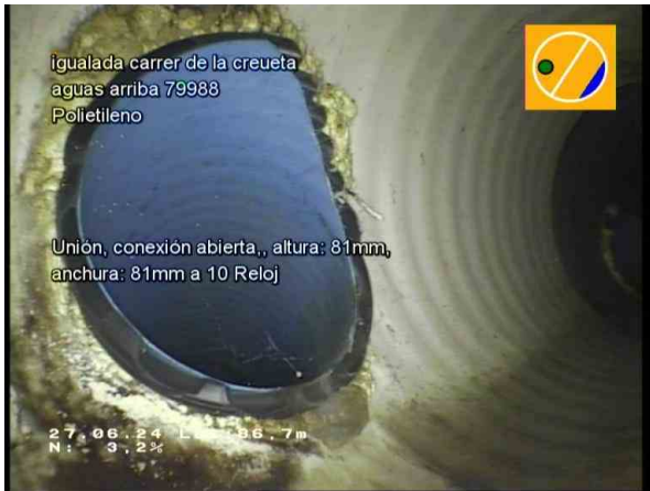
29763_5a39d45f-0a0b-47d8-83a6-4b4b3d9b0c00_20240627_095154_654.jpg, 00:22:03, 86.70m Unión, conexión abierta., altura: 81mm, anchura: 81mm a 10 Reloj
