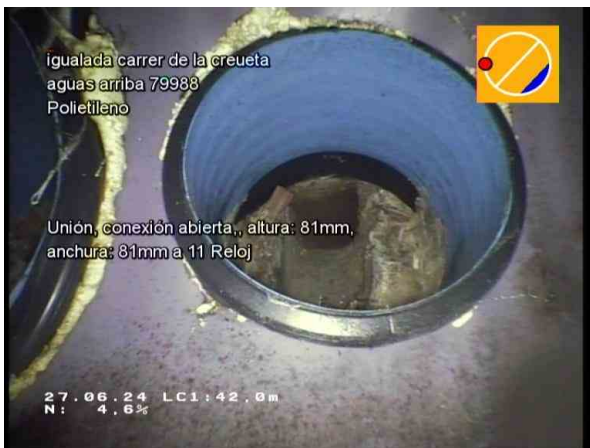
29763_9ea148e9-c838-4c98-a1c0-03d133bc8d36_20240627_093159_935.jpg, 00:08:59, 42.00m Unión, conexión abierta., altura: 81mm, anchura: 81mm a 11 Reloj
