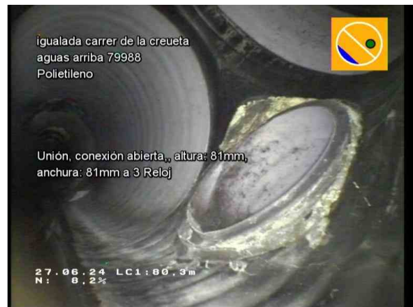
29763_ff4f3390-5aee-41da-bbfe-f7d3b9cb4456_20240627_094510_519.jpg, 00:19:55, 80.30m Unión, conexión abierta., altura: 81mm, anchura: 81mm a 3 Reloj
