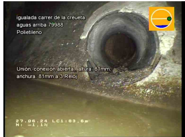
29763_156555b9-1cb0-48f7-8a09-9caa8054402e_20240627_094934_655.jpg, 00:20:45, 83.60m Unión, conexión abierta., altura: 81mm, anchura: 81mm a 3 Reloj
