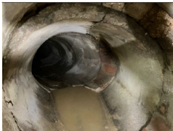
Detall de l'inici de la zona on el col·lector està aixafat i esquerdat.
