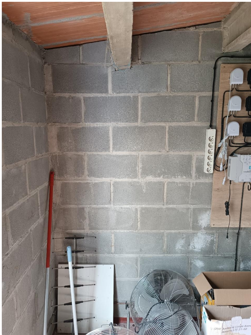
Fig. 4 Vista detall ubicació inversor a l'interior de la caseta annexa al dipòsit
