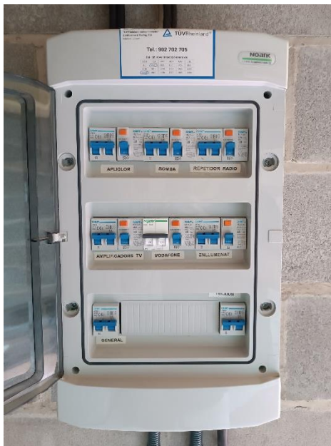
Fig. 5 Vista ubicació del quadre de proteccions monofàsica de la instal·lació dins l'edifici annex al dipòsit
