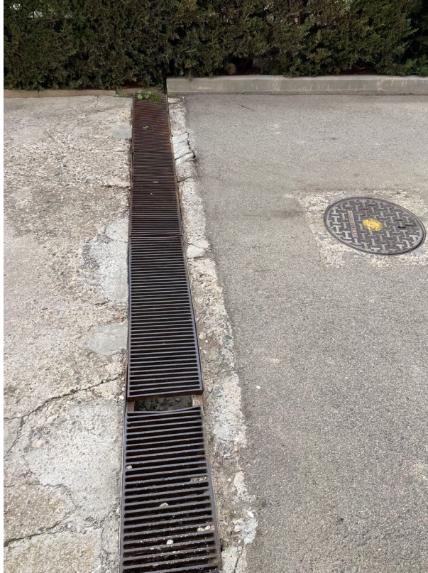
Imatge de l'interceptor del costat del P-3 en mal estat
