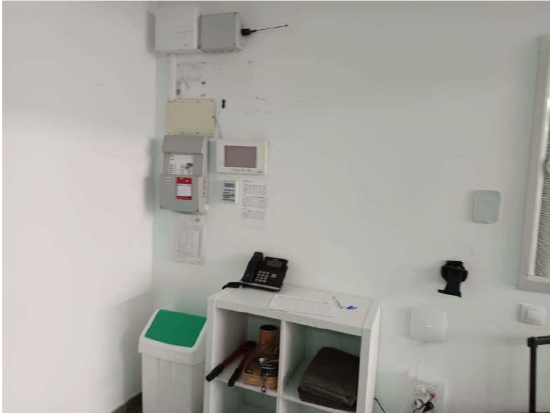
Espai costat de recepció. Ubicació de la central d'incendis
