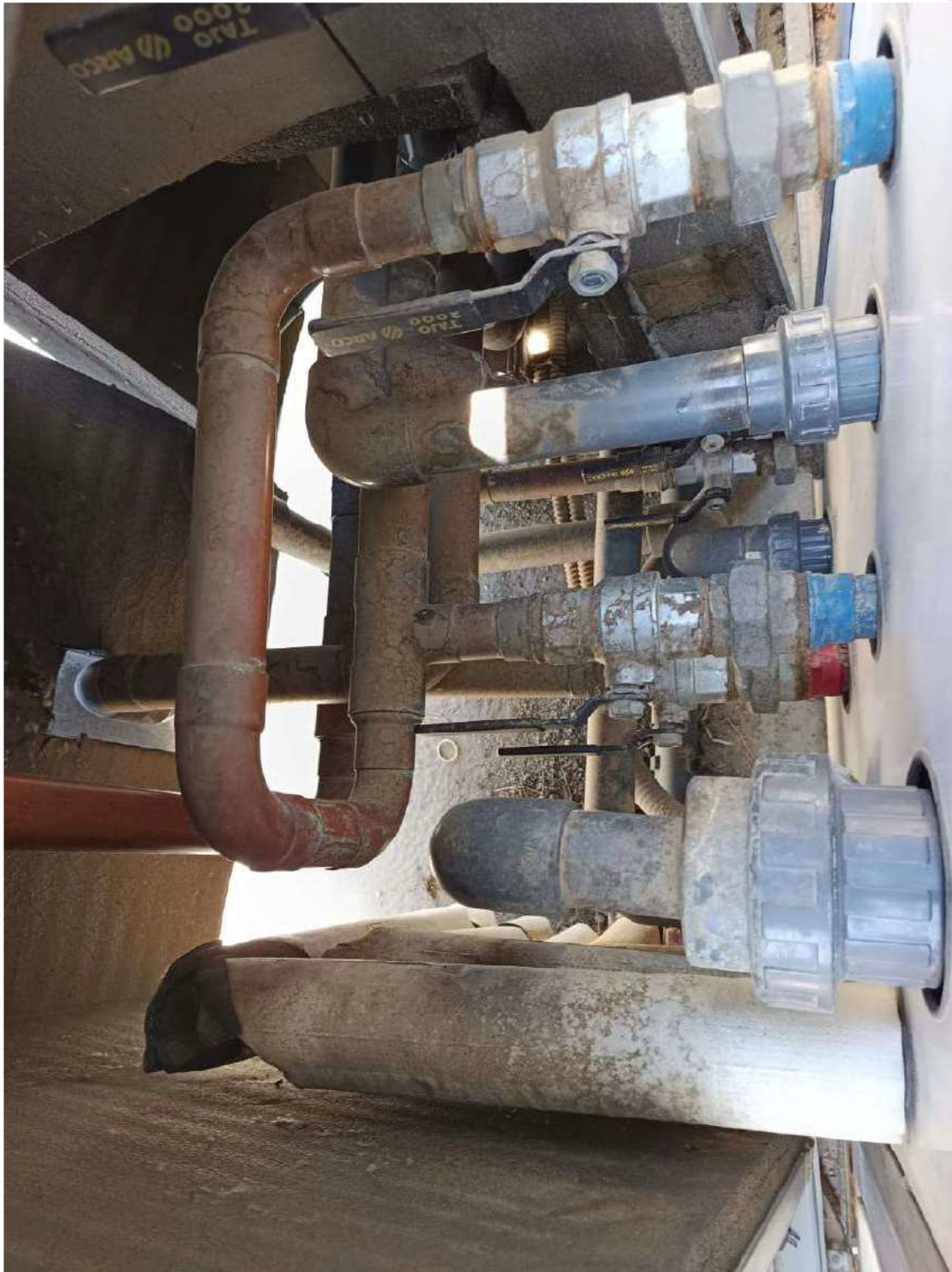
Vista per dins de la caixa de xapa. Vista des de dalt de les derivacions del circuit caldera-deshumectadora als diferents equips que alimenta (bateria calor i bescanviadors escalfament piscina)
