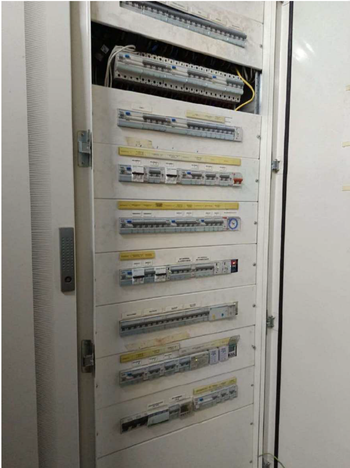
Quadre general d'on alimentar el subquadre deshumectadora
