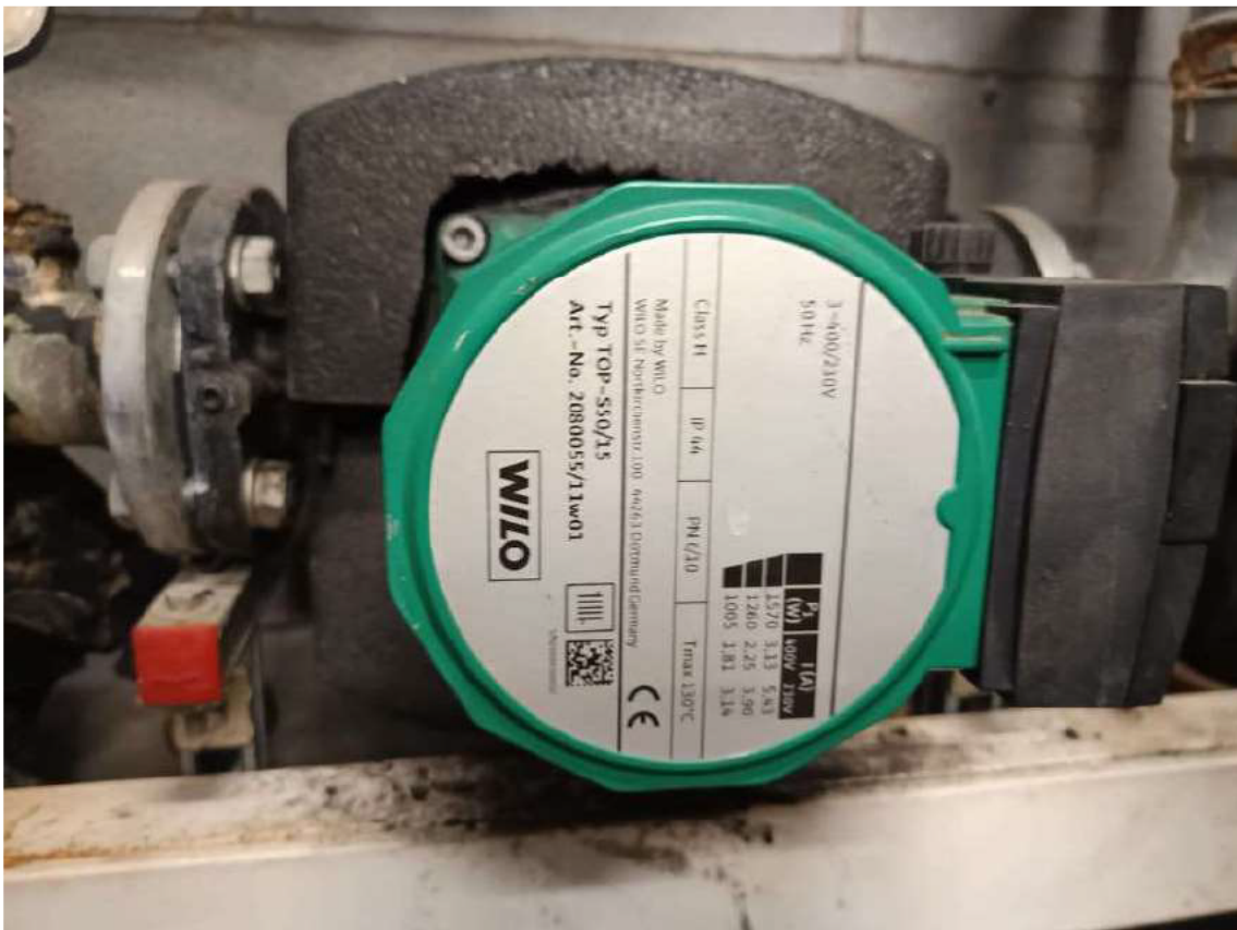
Detall grup de bombeig deshumectadora i escalfament aigua piscina
