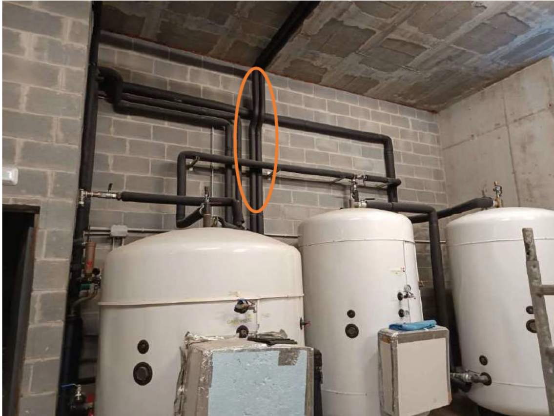
Vista acumulació ACS. El primer dipòsit és el solar d'on surt el circuit a eliminar
