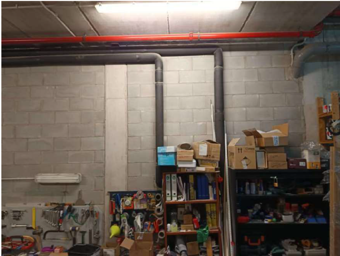
Zona sota piscina. Paret mitgera amb sala calderes. Traçat circuit caldera-deshumectadora
