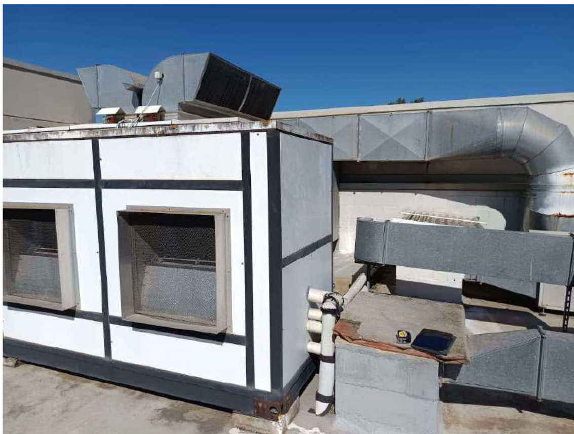
Vista frontal de la bomba de calor a desmantellar
