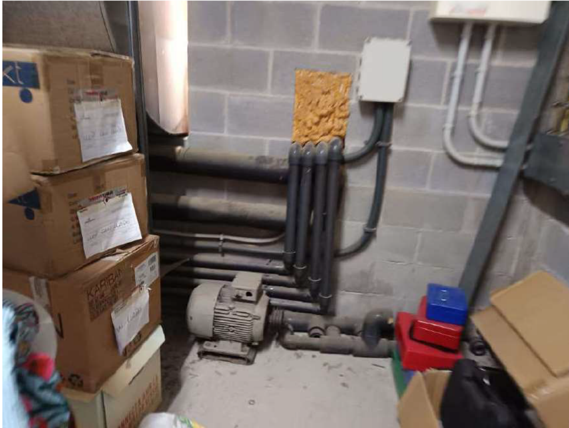
Detall del traçat de canonades i elèctric. Ve pel muntant de canonades vertical, travessa el local i punxa directe a coberta protegit per una coberta de xapa
