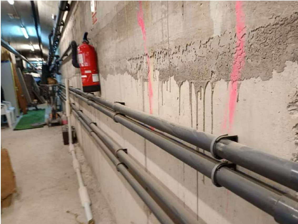
Sota piscina. Traçat circuit secundari escalfament aigua piscina pel lateral de la paret de la piscina gran cap al sector de filtratge
