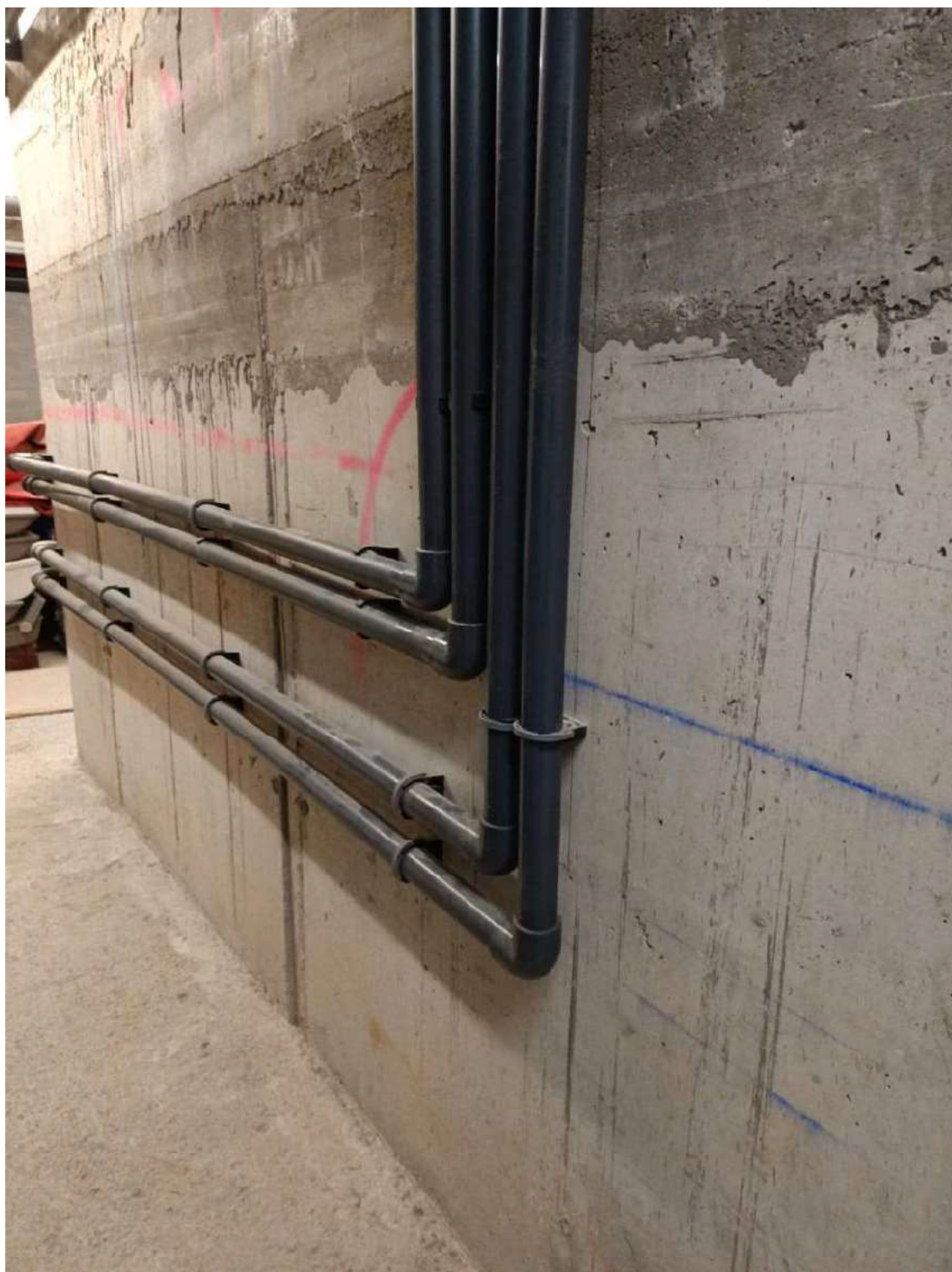
Paret oposada al muntant. Traçat de les canonades circuit secundari escalfament aigua piscina.
