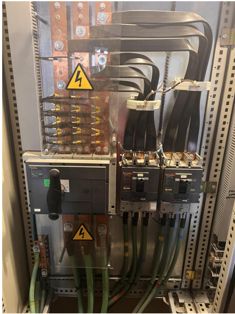
Foto: Subquadre clima existent
