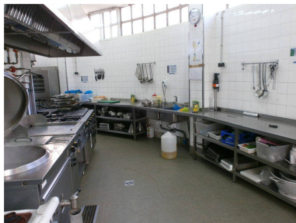
Mostrador de càrrega i pica de dos sens de 9 m de longitud total
