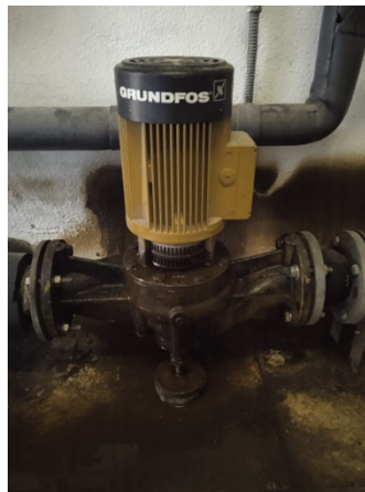
Bomba Impulsora Principal Grundfos
