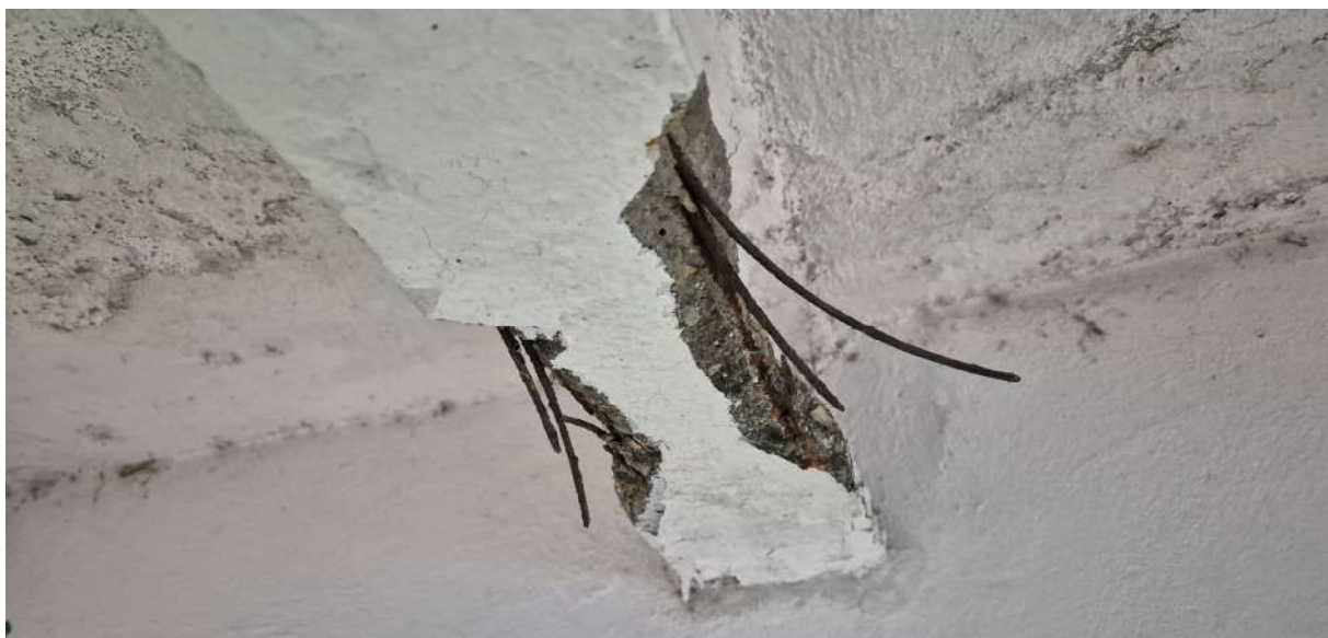
Imatge 1. Bigueta malmesa per l'oxidació de les armadures. Font: Pròpia
