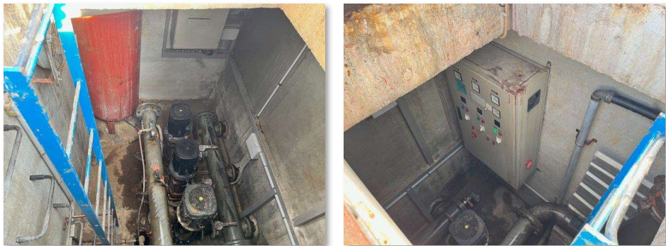
Imatges de l'interior de la cambra del GP XI
