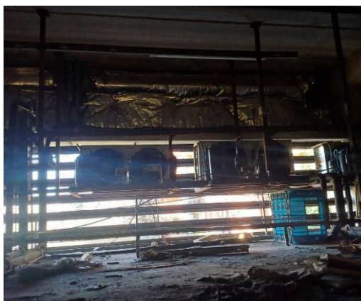
Unitats exteriors existents, compressors
