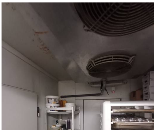
Unitats interiors en càmera frigorífica existent.
