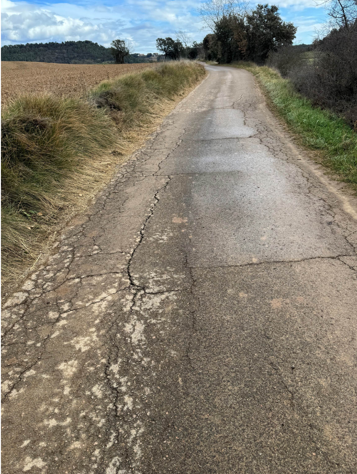
Actuació 3. Patologia típica que presenten aquests dos trams: esquarteraments i, a vegades, enfonsaments de la subbase.
