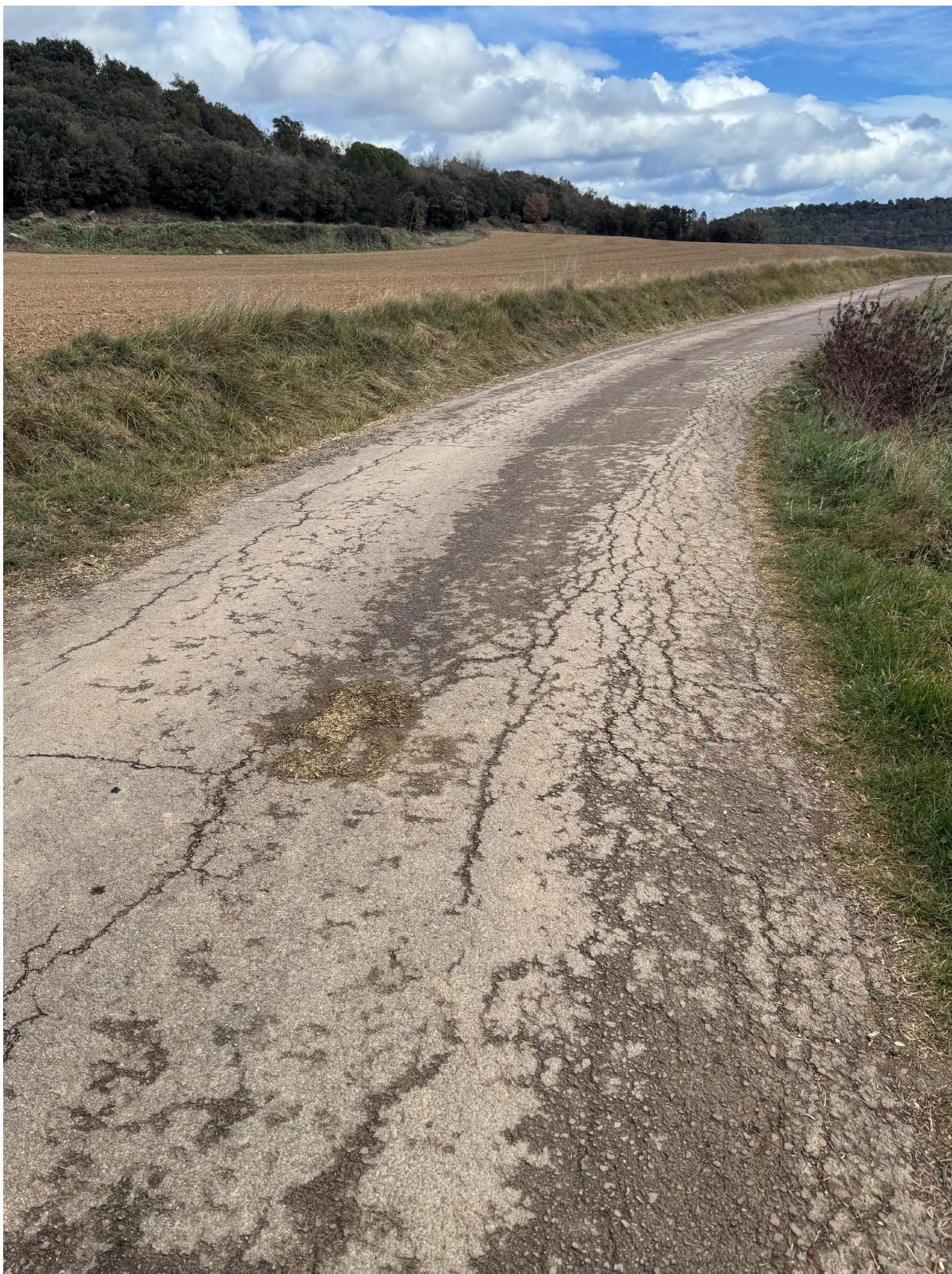
Actuació 1. Patologia típica que presenten aquests dos trams: esquarteraments i, a vegades, enfonsaments de la subbase.
