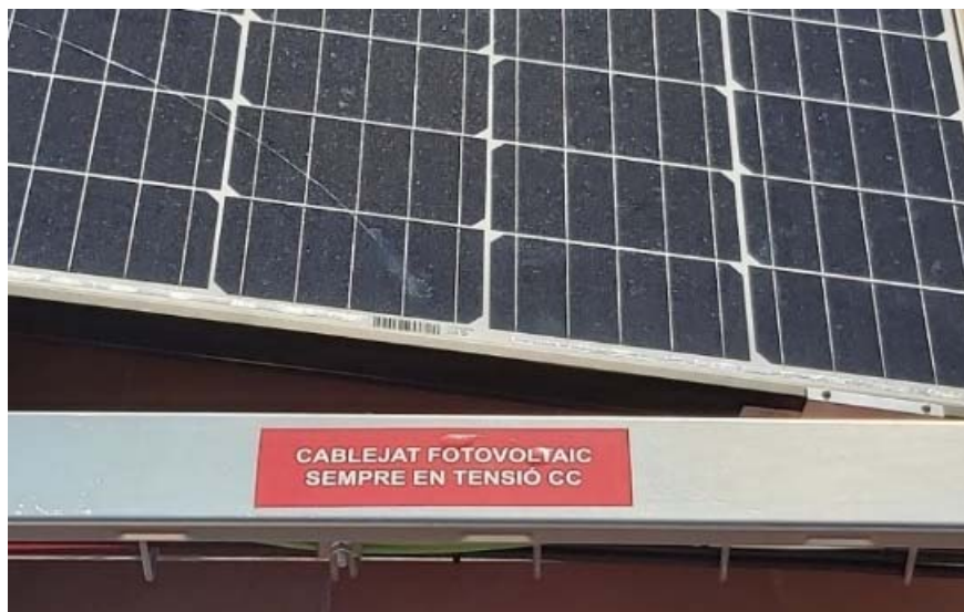
Imatge 5. Exemple de safata metàl·lica per cablejat de CC
