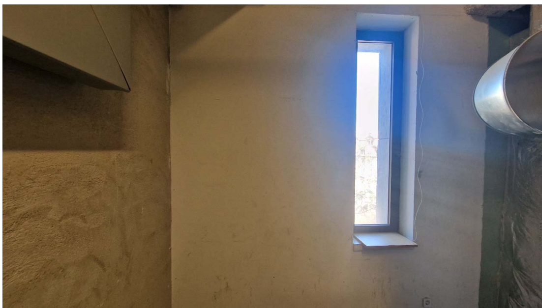
Imatge 19. Espai per emplaçament equips a la sala tècnica
