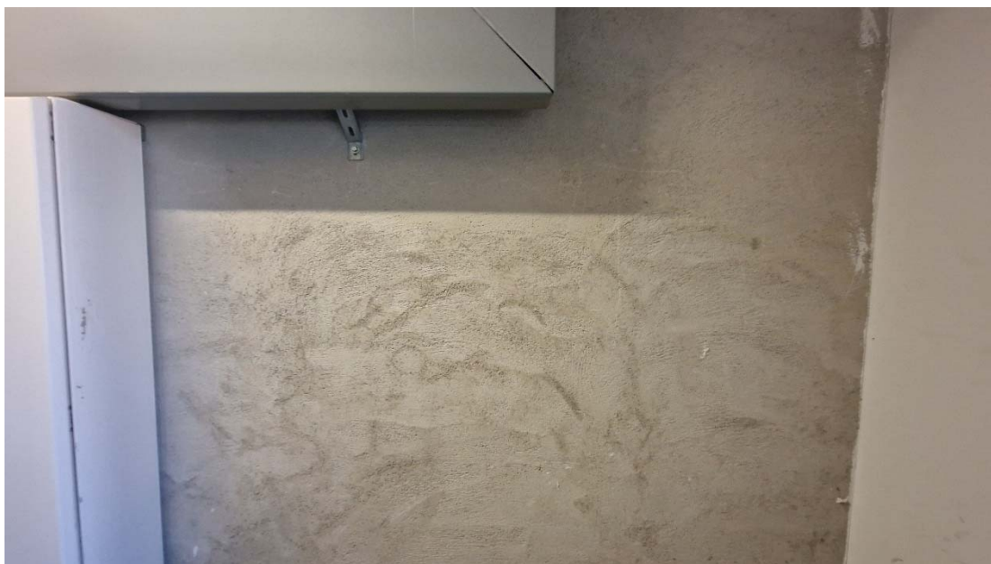
Imatge 18. Espai per emplaçament equips a la sala tècnica
