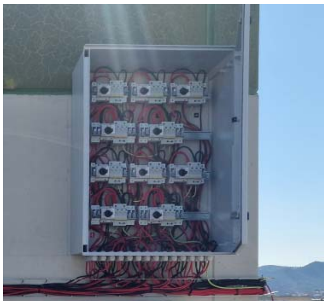
Imatge 11. Exemple de caixa de protecció CC
