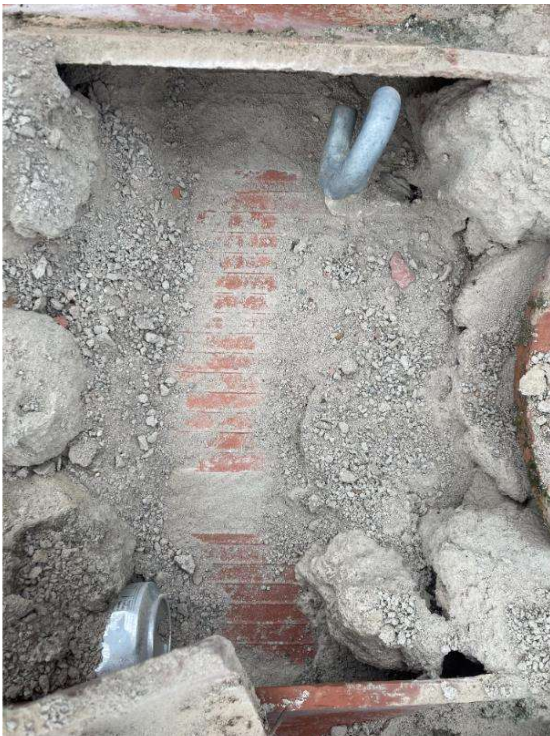
Estat actual del morter de subjecció de les teules
