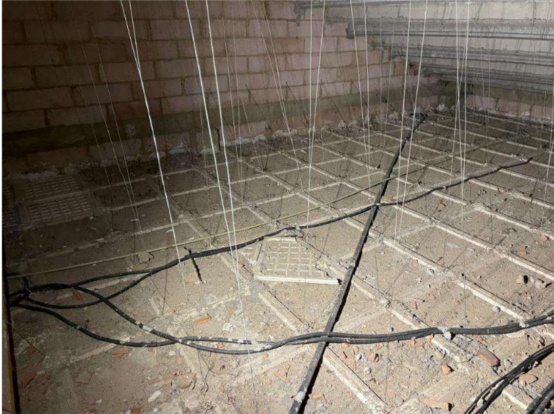
Estat actual plaques d'escaiola del fals sostre
