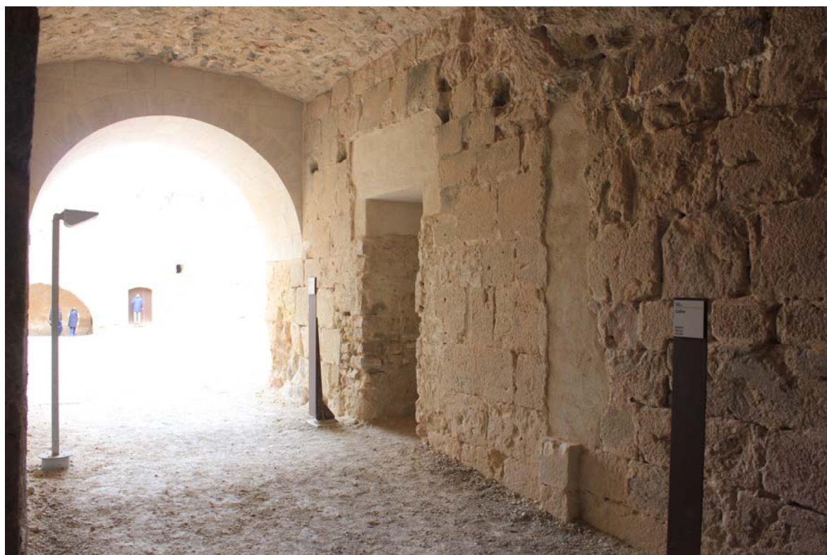
Fotografia 13. Vista que mostra el tancament lateral del passadís d'accés on s'aprecia l'empremta de la porta
