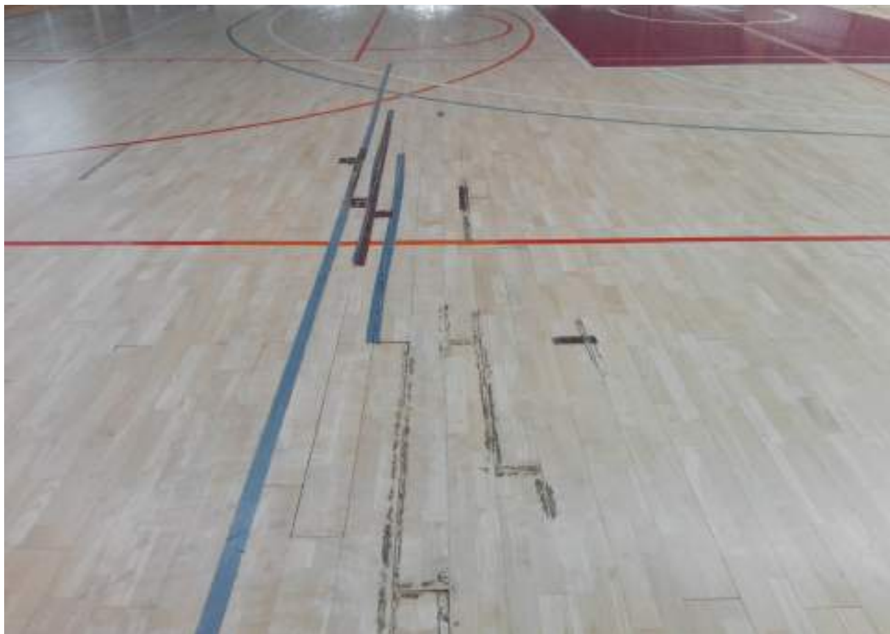
Paviment actual pavelló municipal d'esports. Detall desperfectes.
