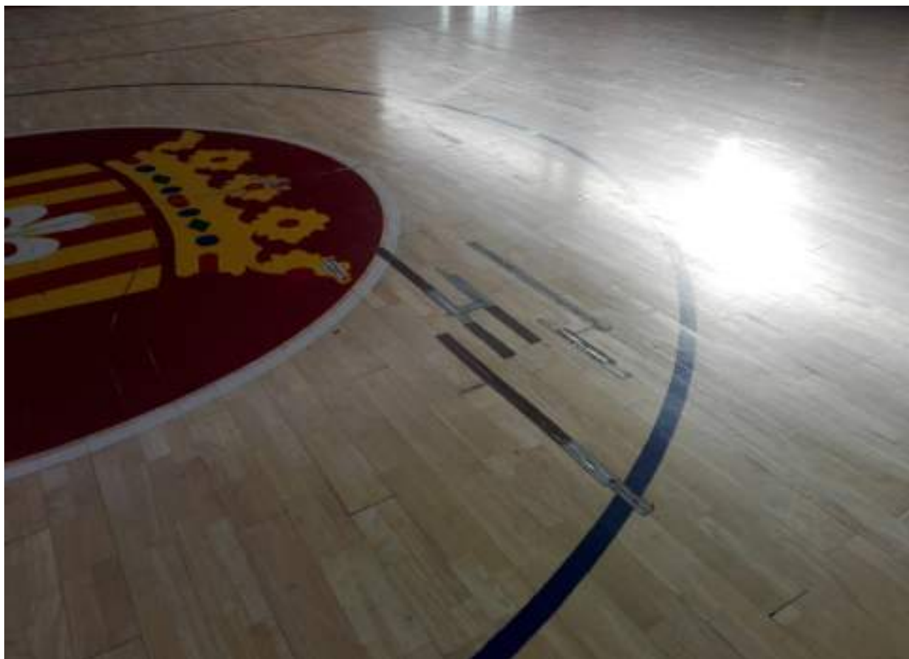
Paviment actual pavelló municipal d'esports. Detall desperfectes.
