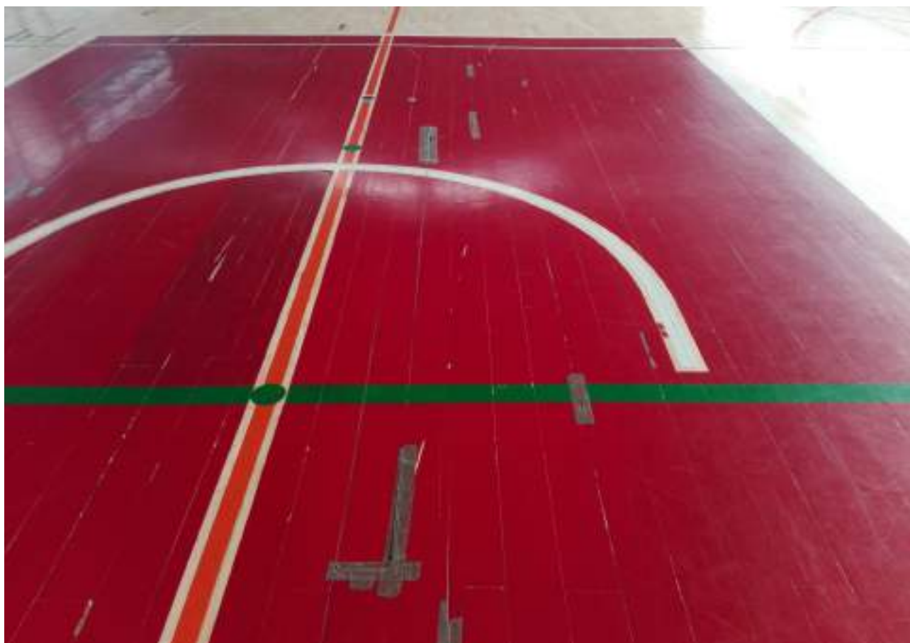
Paviment actual pavelló municipal d'esports. Detall desperfectes.
