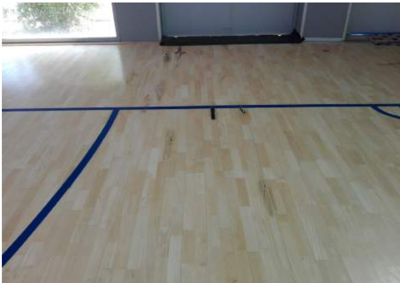
Paviment actual pavelló municipal d'esports. Detall desperfectes.
