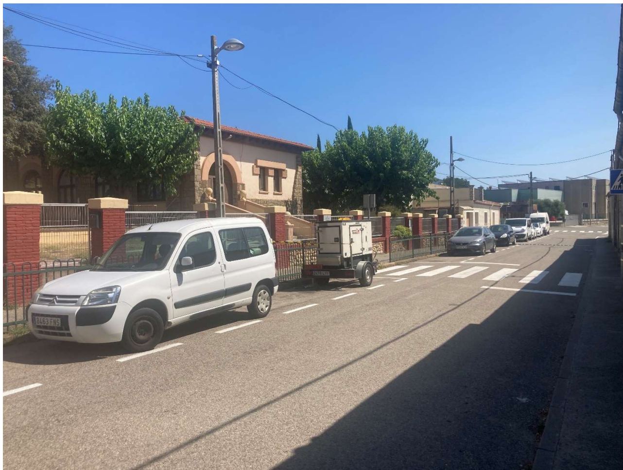
Fotografia 3: Grup electrògen dedicat per al suministre elèctric
