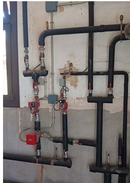
Imatge 2. Instal·lació hidràulica sala calderes (Font: Energi)
