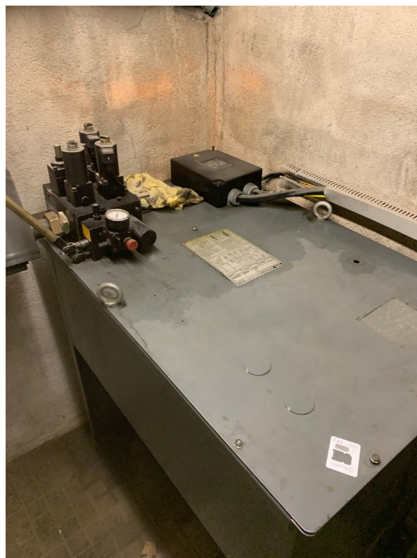
Detall del grup hidràulic substituït.
