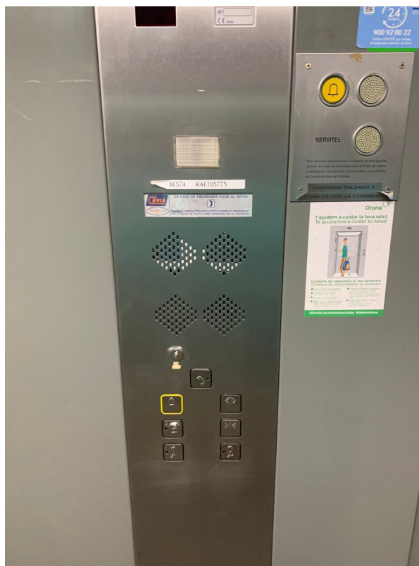
Detall de la botonera interior de cabina.
