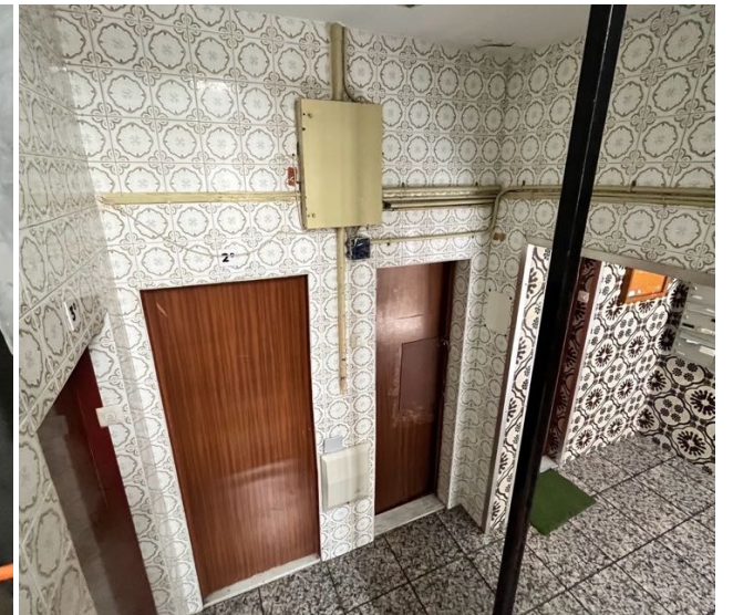
I-ELE Caixa general Elèctrica
