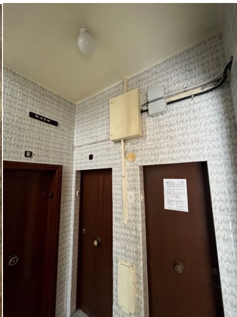
I-ELE Caixa distribució Elèctrica
