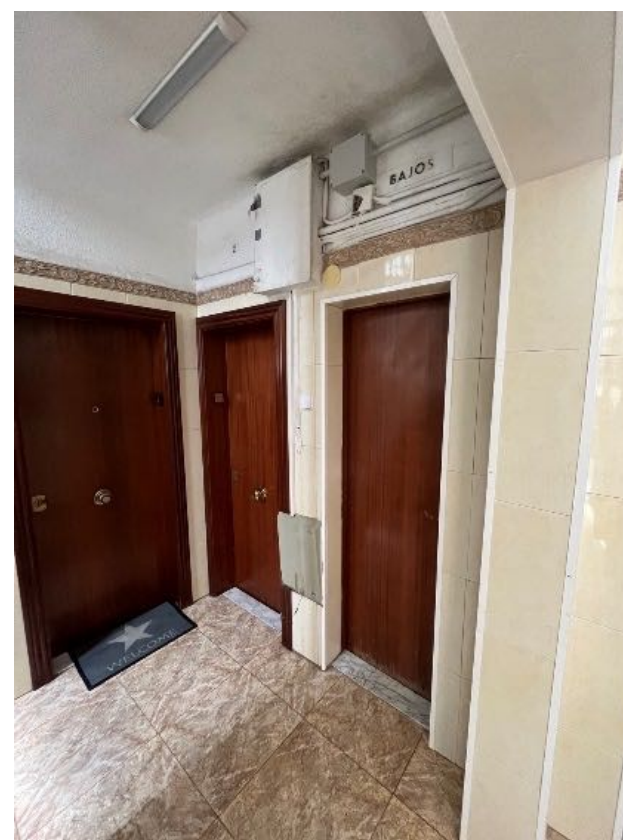
I-ELE Caixa distribució Elèctrica en PB
