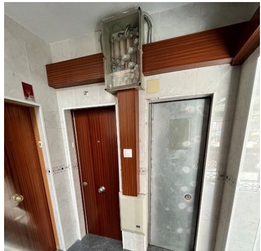
I-ELE Caixa general Elèctrica
