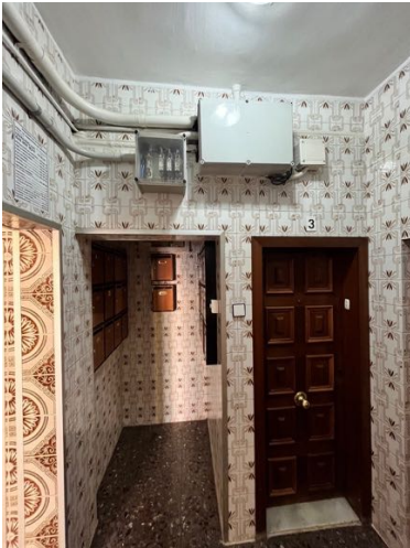
I-ELE Caixa general Elèctrica
