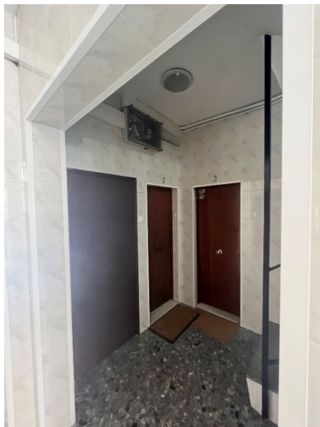
I-ELE Caixa distribució Elèctrica
