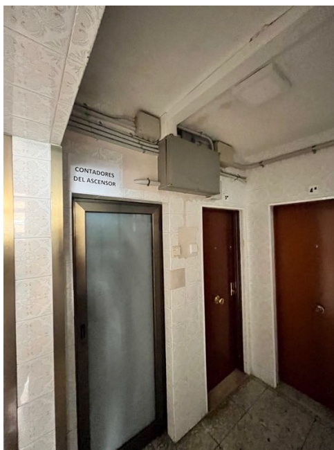
I-ELE Caixa distribució Elèctrica
