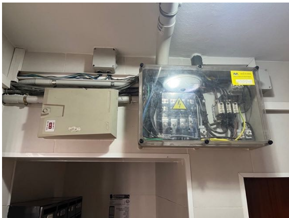
I-ELE Caixa general Elèctrica
