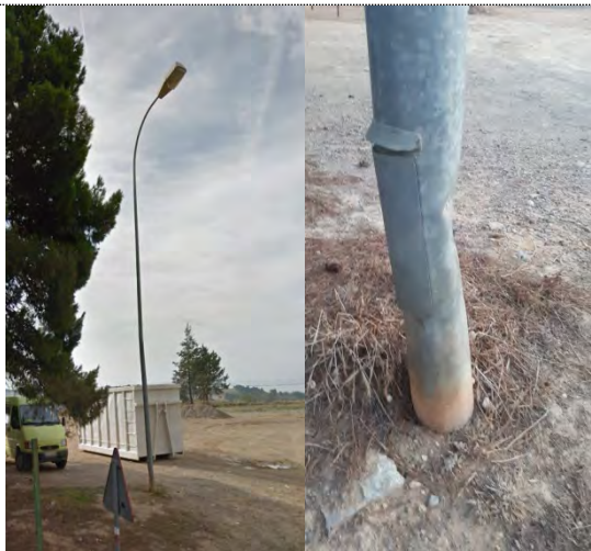
Luminària Sobre Pal de Formigó LIF148
