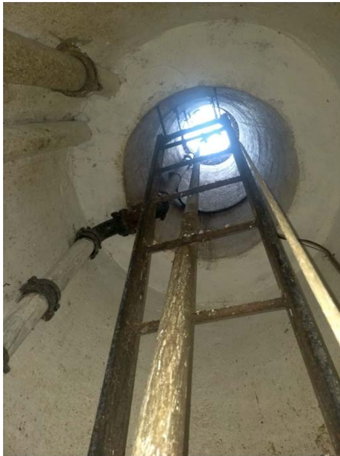
Detall del darrer tram de l'escala amb la llosa del fons del dipòsit al pla mitjà i el forat d'accés a la coberta sense cap trampeta al fons.
