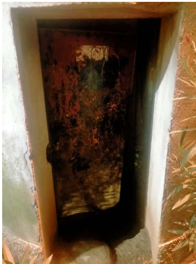
Detall de la porta d'entrada al dipòsit, actualment trencada.
