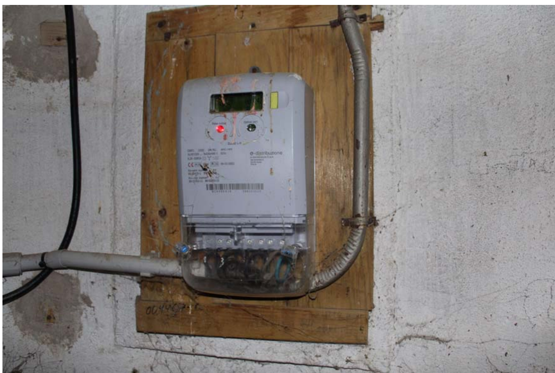
Comptador elèctric present a l'interior del dipòsit.
