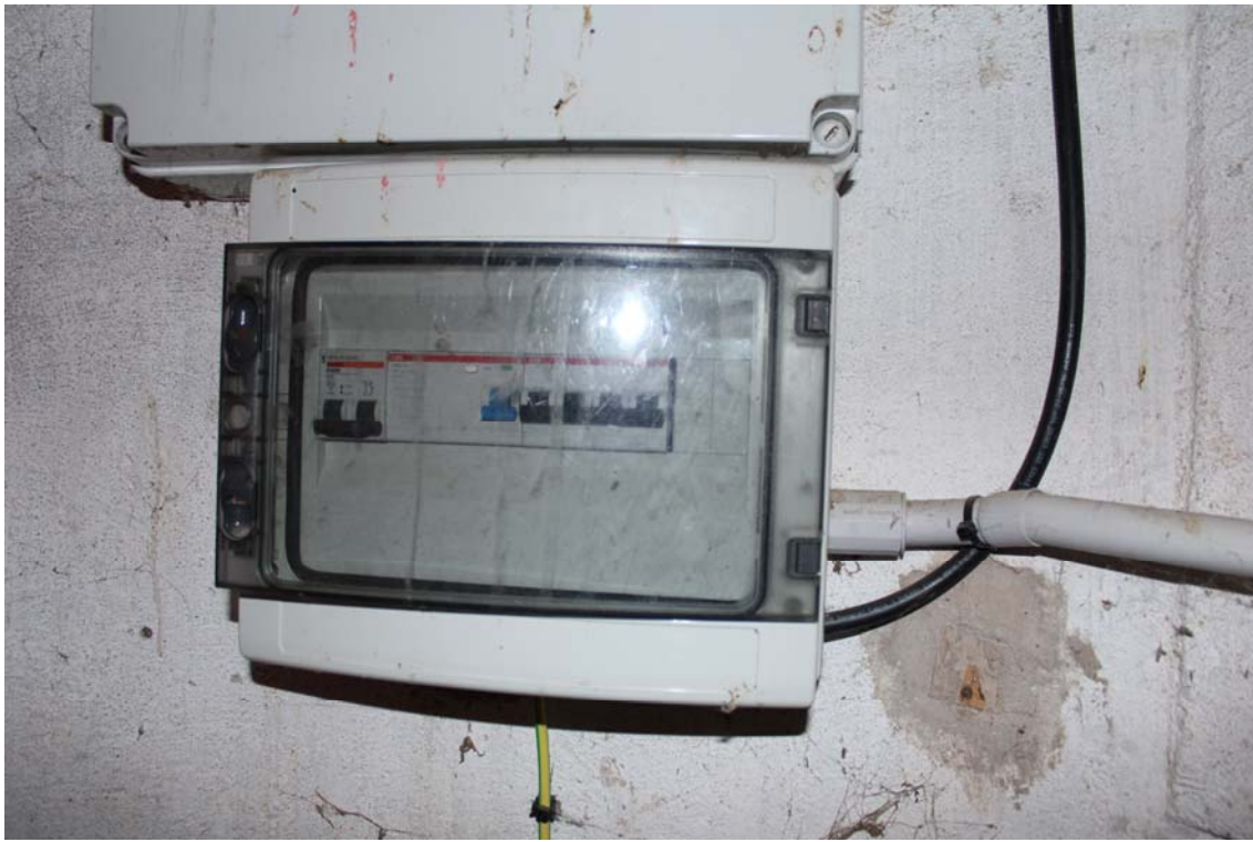
Quadre de comandament de la instal·lació elèctrica.
