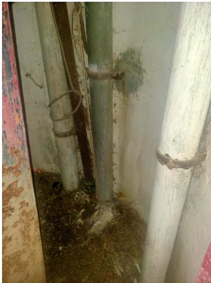
Detall dels conductes d'entrada i des sortida del dipòsit, alguns d'ells de fibrociment amb presència d'amiant, i detall de la colomassa acumulada al terra de la planta baixa.
