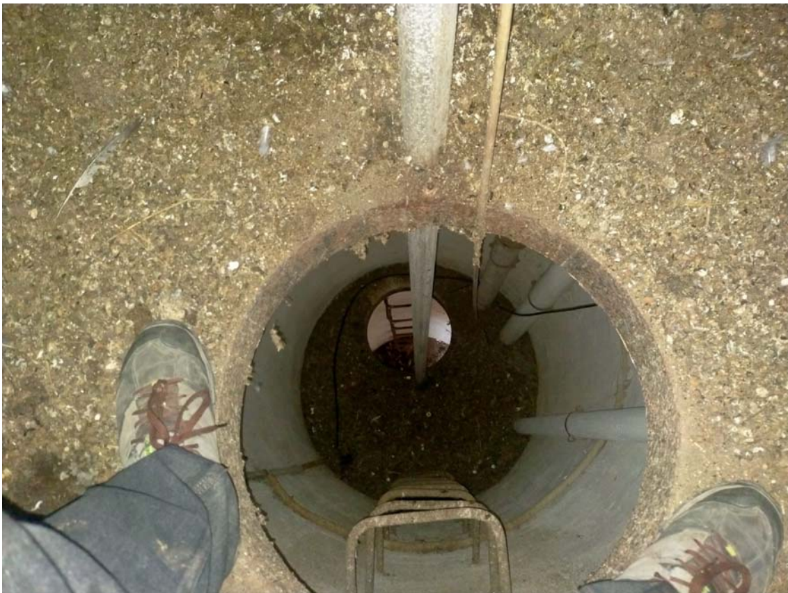
Vista contra picada dels sostres dels replans, amb força presència de colomassa.
