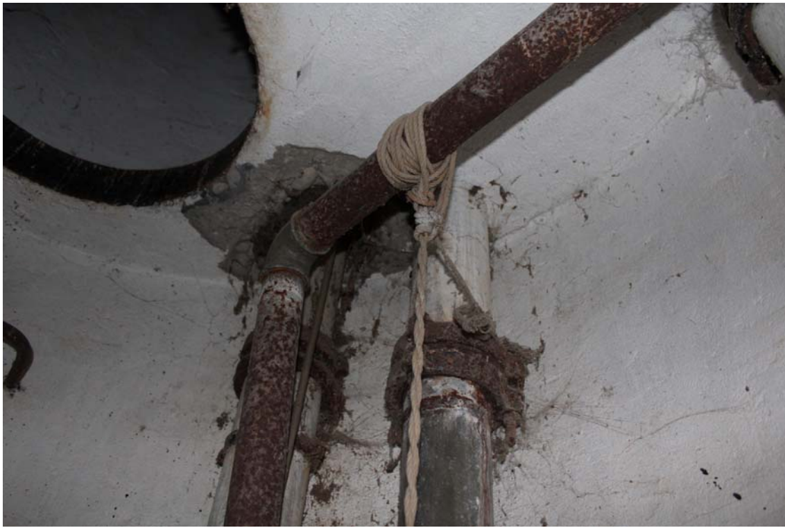
Detall de l'estat de conservació de les instal·lacions d'abastament d'aigua amb oxidació i corrosió dels elements metàl·lics.
