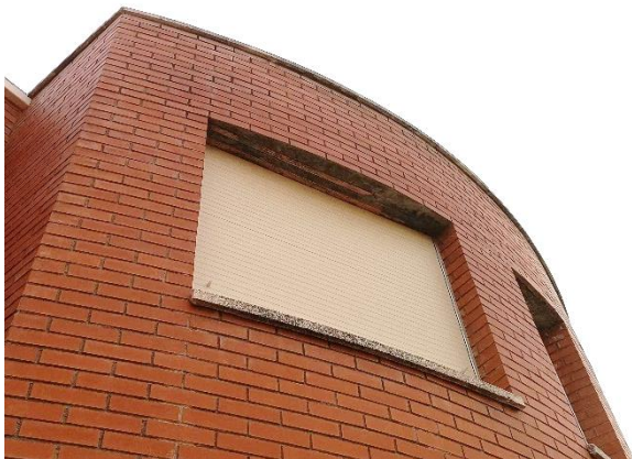
Imatge 3: Despreniment del morter de revestiment i signes d'òxid de la llinda d'acer
