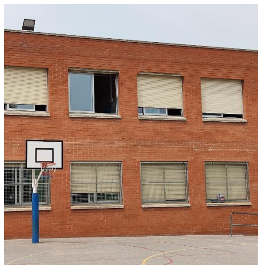
Imatge 2: Façana amb desprendiment de pitxolí en la zona de la llinda
