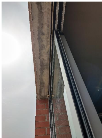
Imatge 10: Llanda de formigó armat amb morter de la zona del pitxolí esquerdat
