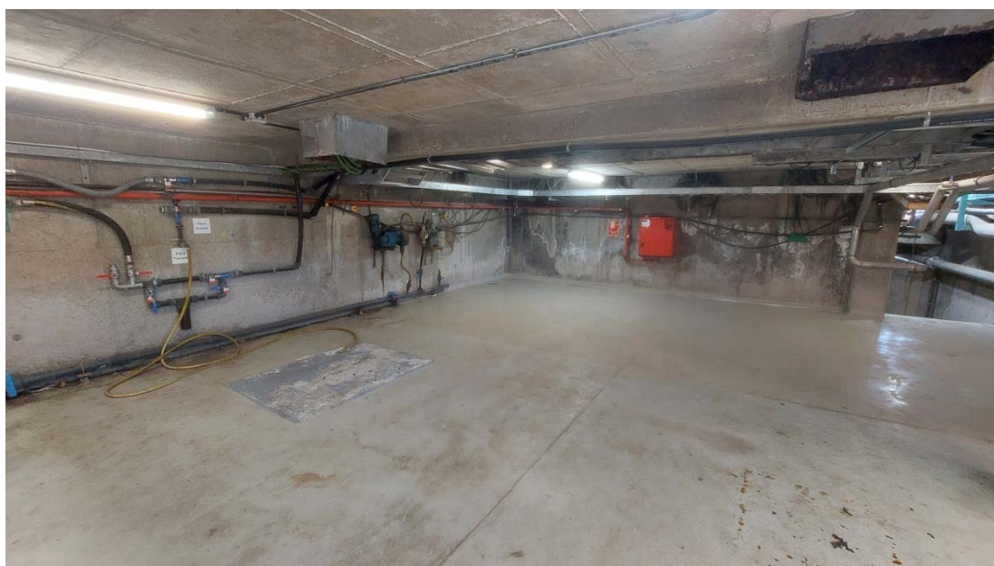
Imatges de la planta baixa sota la nova sala de instal·lacions de l'edifici de deshidratació.
