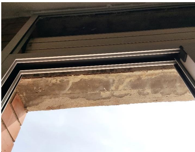
Imatge 5: Llinda de formigó amb l'armat exposat i rovellat
