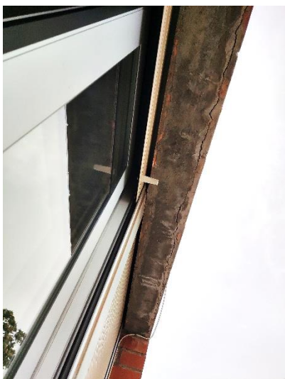
Imatge 9: Llanda amb perfils d'acer amb morter esquerdat a la zona del pitxolí.
