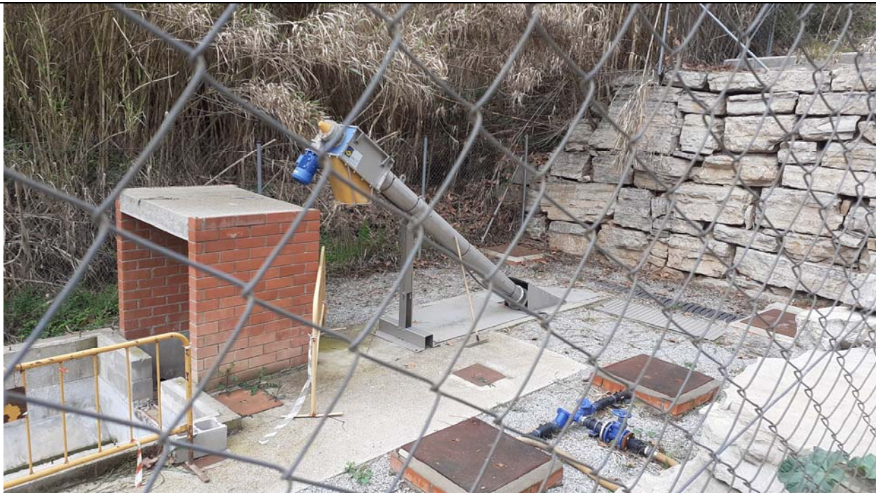
Foto 2. Pretractament i Decantadors primaris
