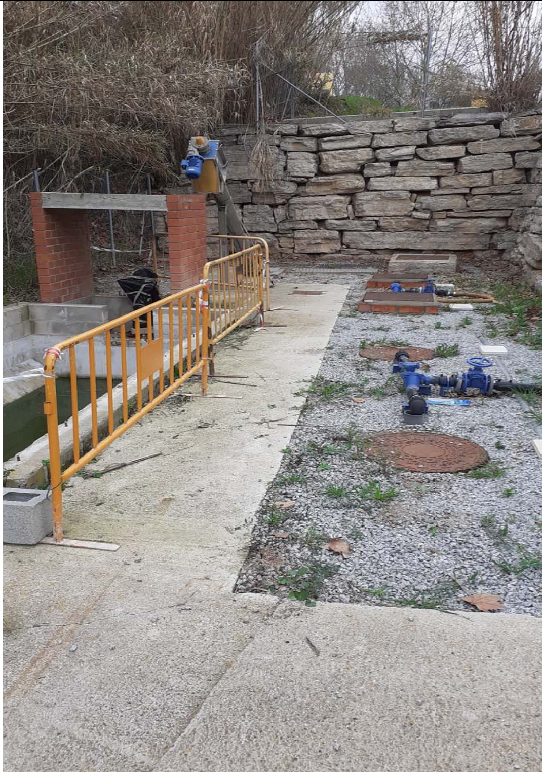
Foto 1. Reactor biològic i decantadors secundaris. .
