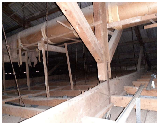
6.Vista general d'instal·lacions col·locades a l'interior, entre l'estructura i el cel ras.
