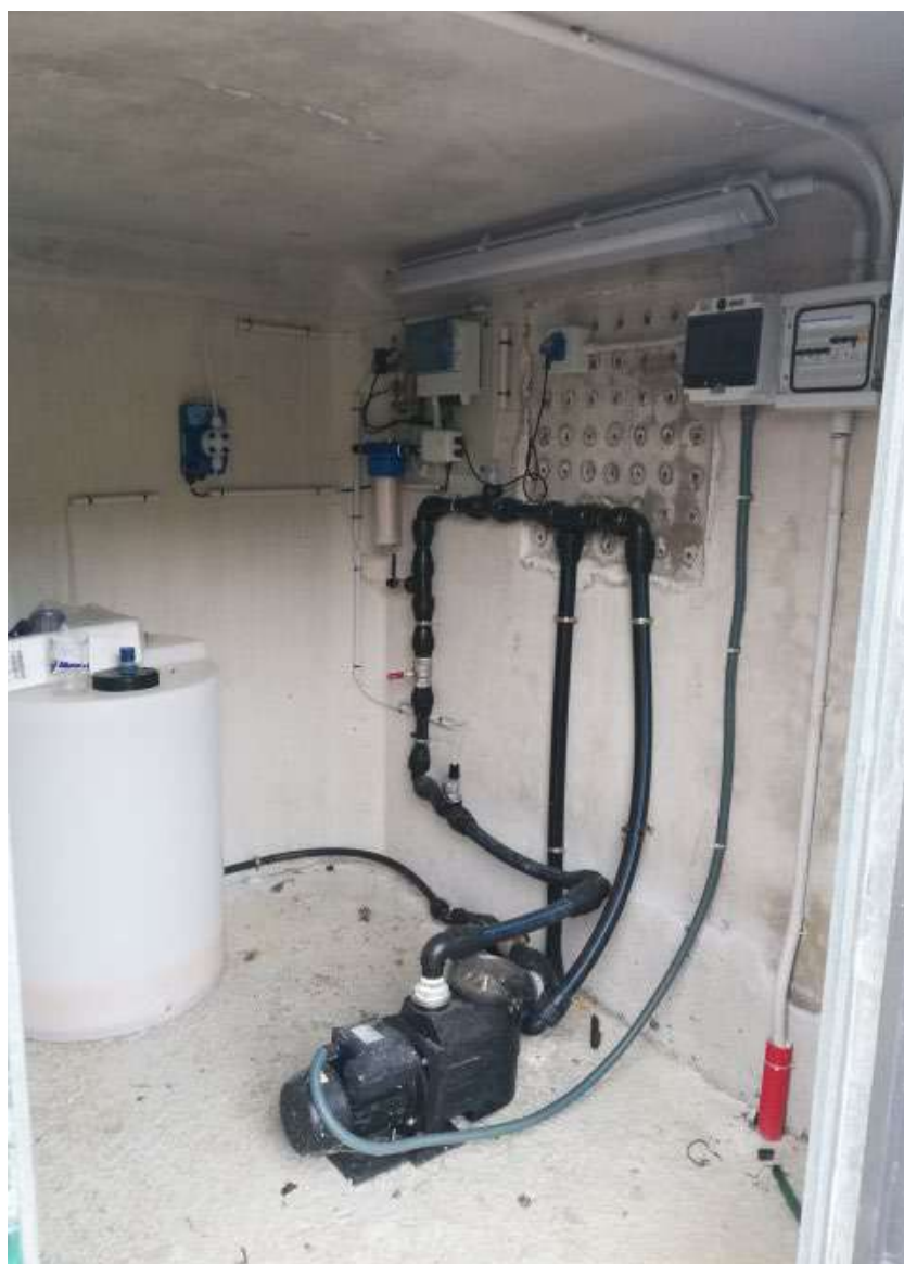
Foto 4: Vista interior caseta instal·lacions de desinfecció existents amb hipoclorit sòdic que estan fora de servei.
