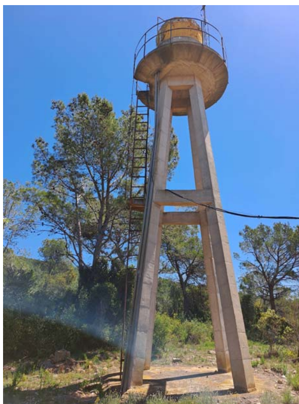
8. Sistema Aiguamúrcia. Dipòsit elevat de l'Albà. Dipòsit distribució.
