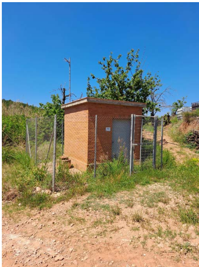
5. Sistema Aiguamúrcia. Pou de l'Albà o Masbarrat. Captació subterrània d'abastament del sistema.
