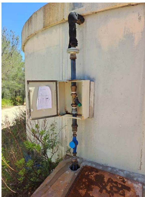
10. Sistema Aiguamúrcia. Dipòsit d'Aiguamúrcia. Entrada al dipòsit.
