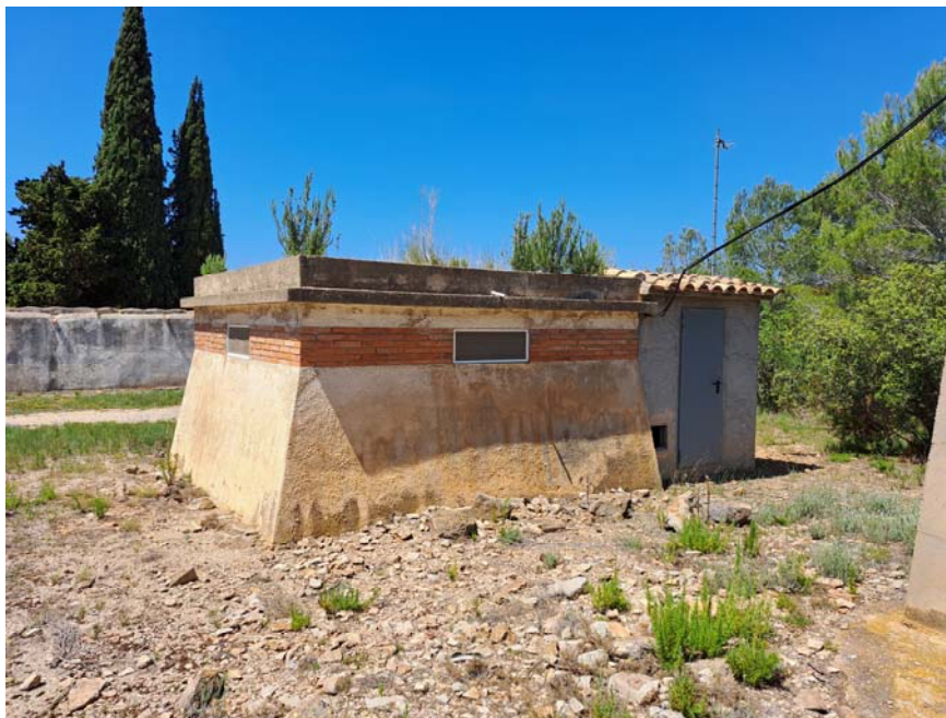
6. Sistema Aiguamúrcia. Dipòsit de l'Albà. Dipòsit de capçalera del sistema. Vista de la caseta per a nova instal·lació elèctrica.
