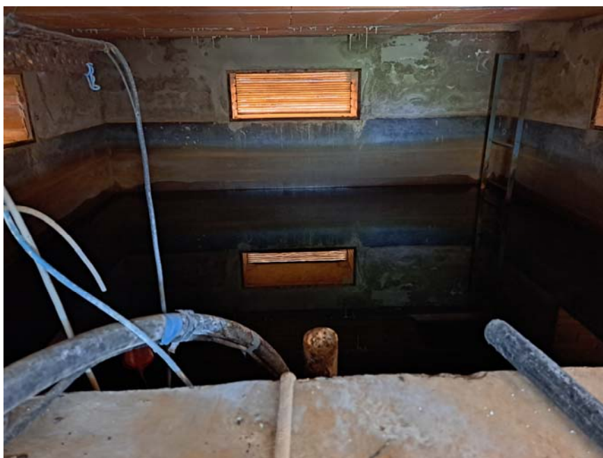
7. Sistema Aiguamúrcia. Dipòsit d'Albà. Dipòsit de capçalera del sistema.
