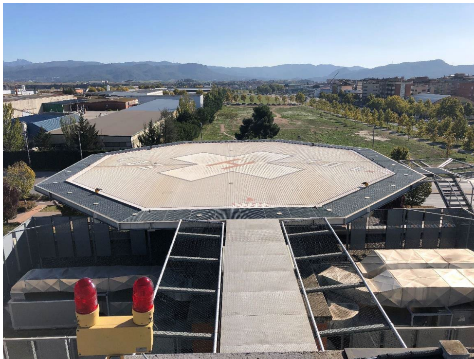
Figura 3. Estat actual de l'àrea de moviment de l'heliport.
