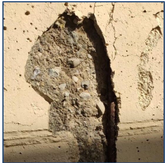
Figura 10- Detall carbonatació del formigó
