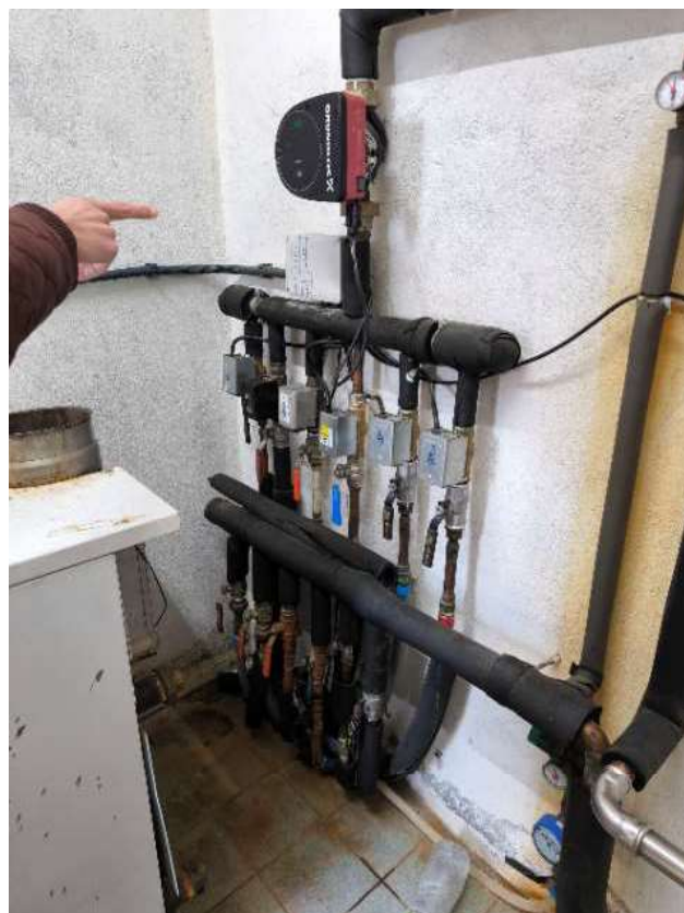
Fotografia 2. Vista de la sala de calderes (col·lector i bomba d'impulsió)
