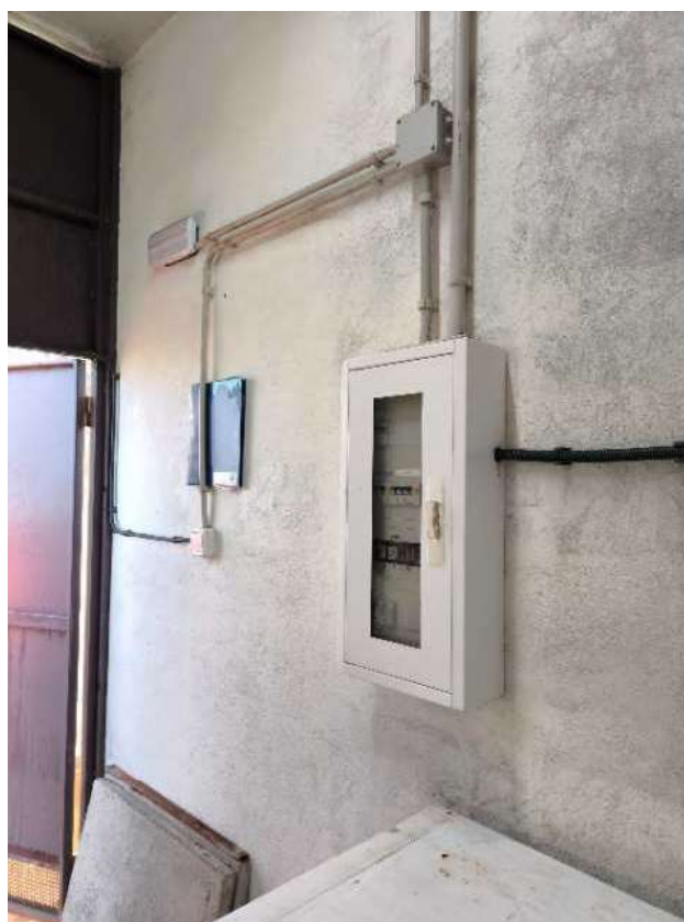
Fotografia 6. Vista de l'actual subquadre elèctric de climatització, a la sala de calderes
