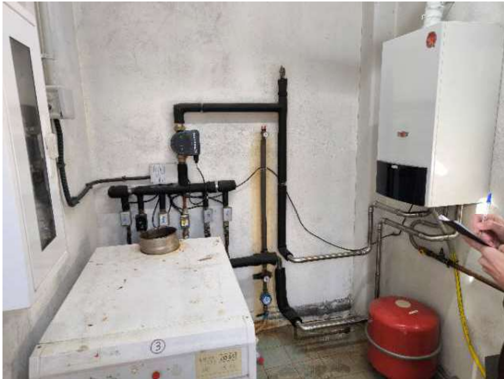
Fotografia 1. Vista general estat actual de la sala de calderes
