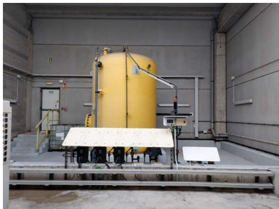
1 - Dipòsit Hipoclorit i bombes dosificadores
