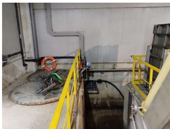
6 - Vàlvules de control hipoclorit
