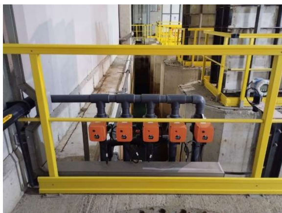
5 - Vàlvules de control hipoclorit
