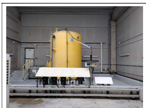
Dipòsit i bombes dosificadores
