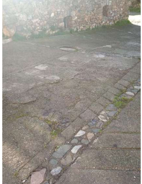
Il·lustració 5: Placeta on s'aprecien tapes a substituir.
