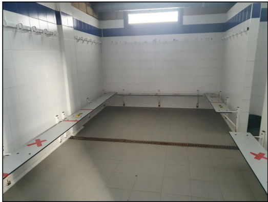
Fotografia 10. Equipament zona canviadors.
