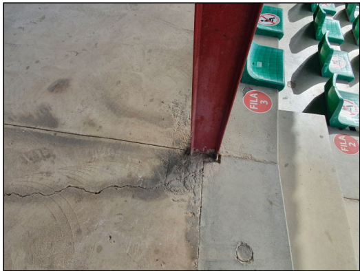
Fotografia 11. Unió encastada amb fissures.
