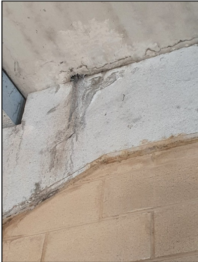
Fotografia 8. Punt de filtracions en el sostre.
