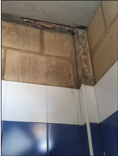
Fotografia 7. Punt de filtracions en el sostre.
