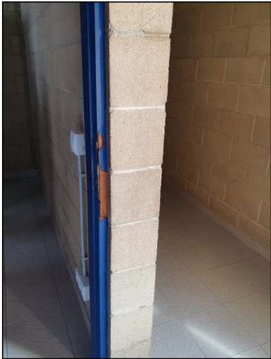
Fotografia 5. Porta accés deteriorada.
