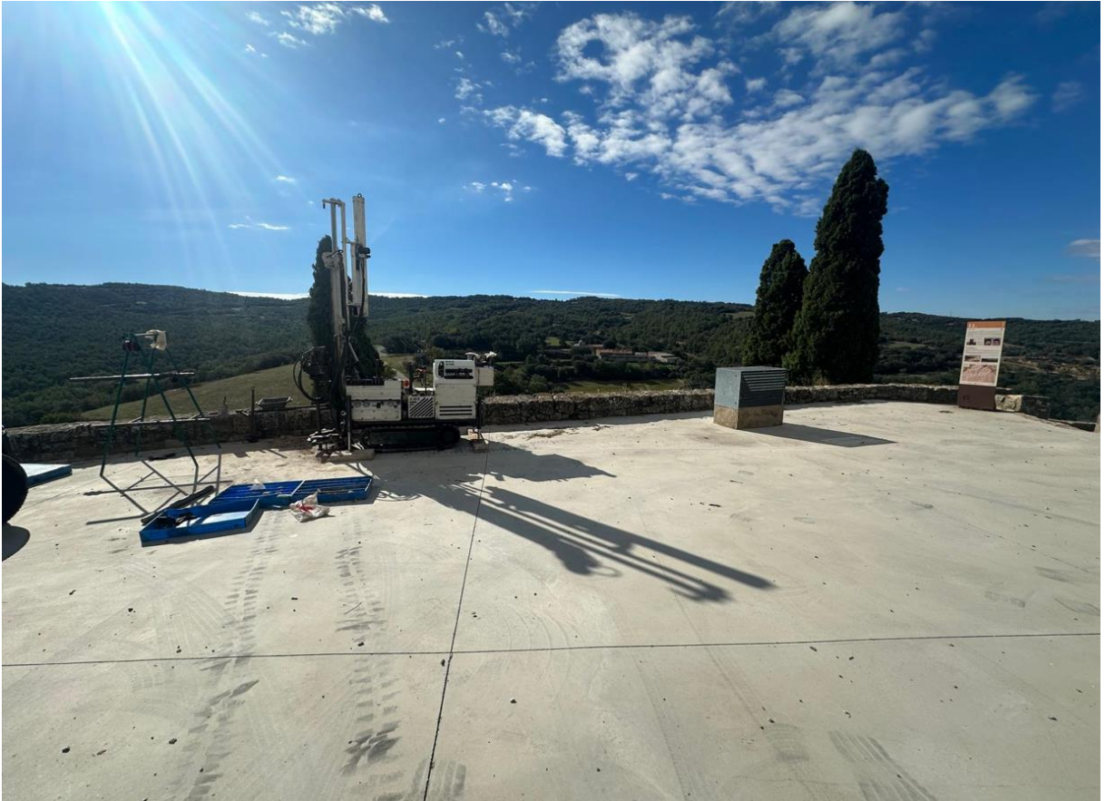
Fotografia de l'emplaçament de la sonda en el punt de sondeig S-1 situat en la plaça del Mirador.
