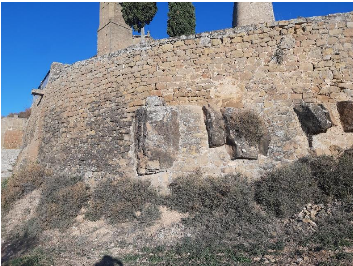
En aquest sector de l'extrem del mur inferior sembla que es troba la base recolza sobre l'estrat d'argiles inferior amb possibles assentaments diferencials que pateix el mur. Els materials es troben exposats a les condicions pluviomètriques alterant el seu estat provocant la inestabilització del mur .
