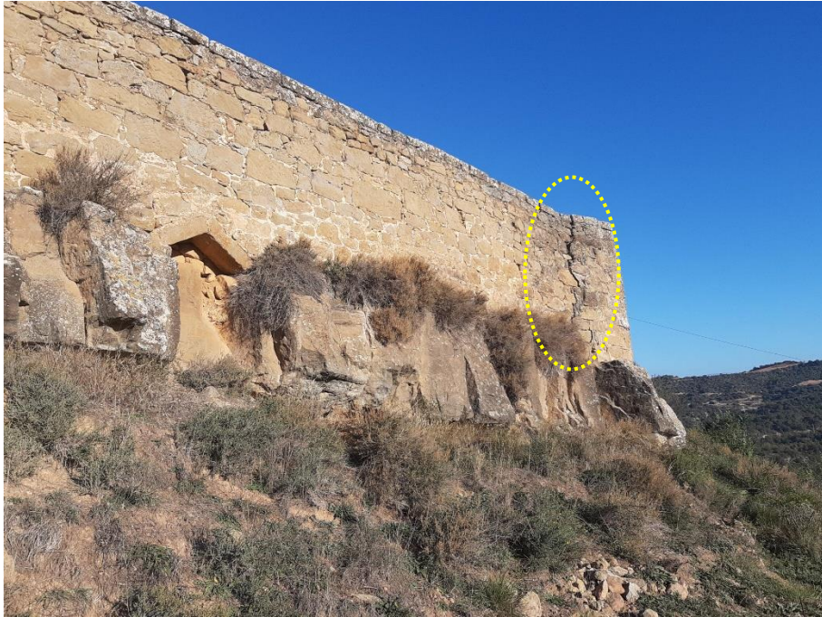
Vista de la punta est del mur, on es pot distingir una fractura vertical important ( fotografia 9).
