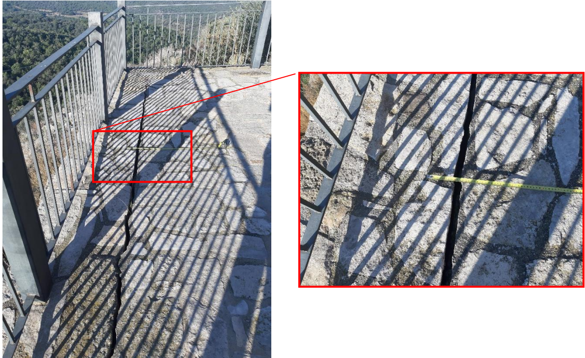
Fotografies de l'estat del paviment de la terrassa / mirador al costat de l'església de Sant Miquel, amb una esquerda de 2 cm d'obertura, indicant la inestabilitat del mur de contenció. ( fotografia 6)
