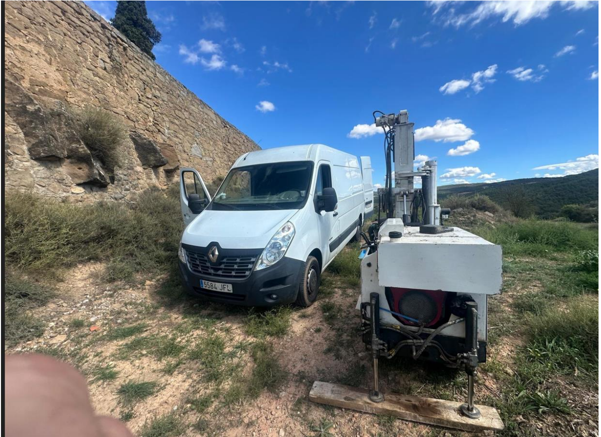
Fotografia de l'emplaçament de la sonda en el punt de sondeig S-3 al peu dels murs.
