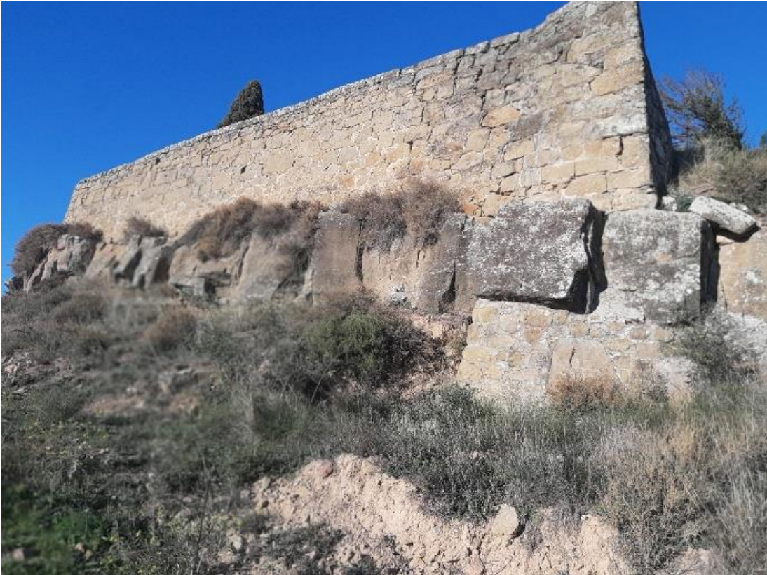
Fotografia de l'estat de fracturació de la capa de gres sobre el que recolza el mur.
