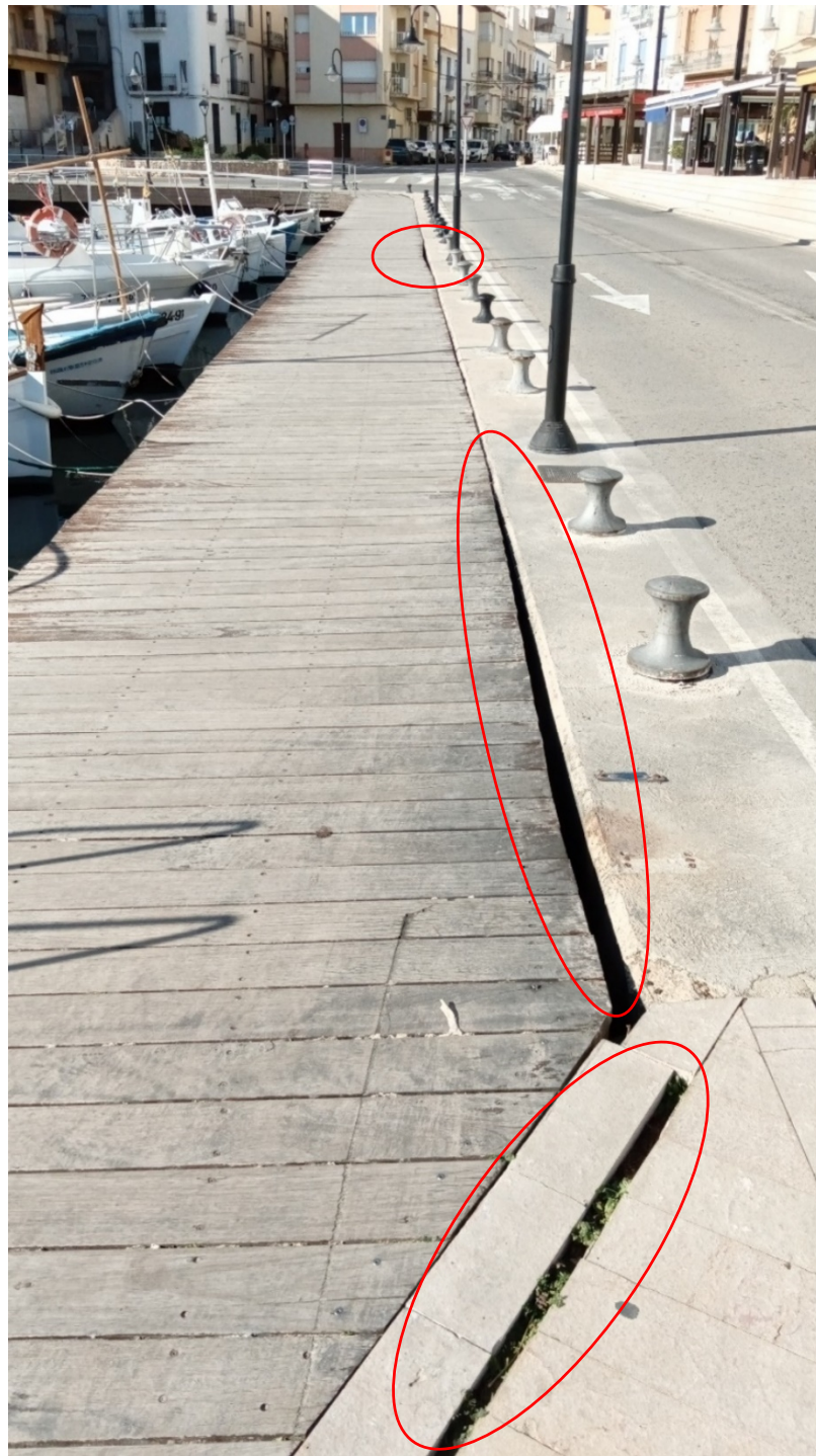
Aspecte de la Zona 1. S'observa la separació entre moll i passarel·la, així com desperfectes en el paviment de la coronació del moll
