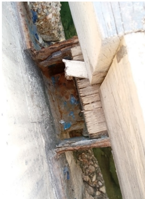
Ancoratges Zona 1 en molt mal estat
