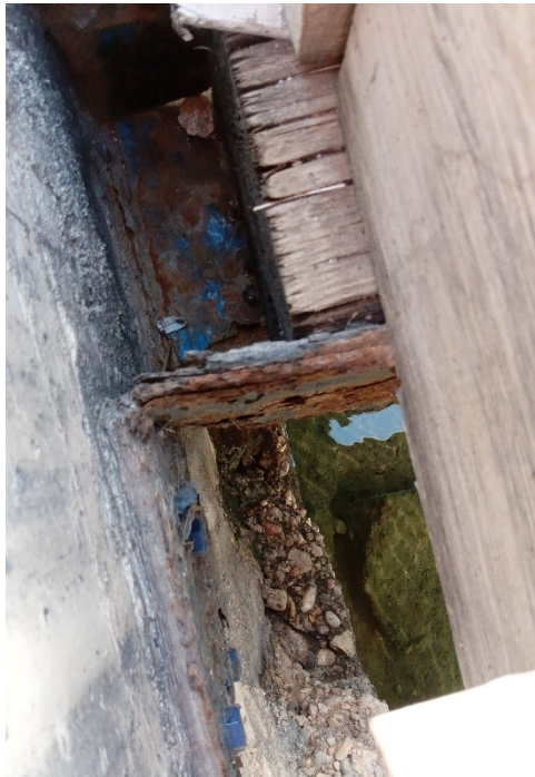
Fotografia 13. Aspecte del recolzament sobre el moll. L'element metàl·lic està força malmès i la biga transversal desplaçada.
