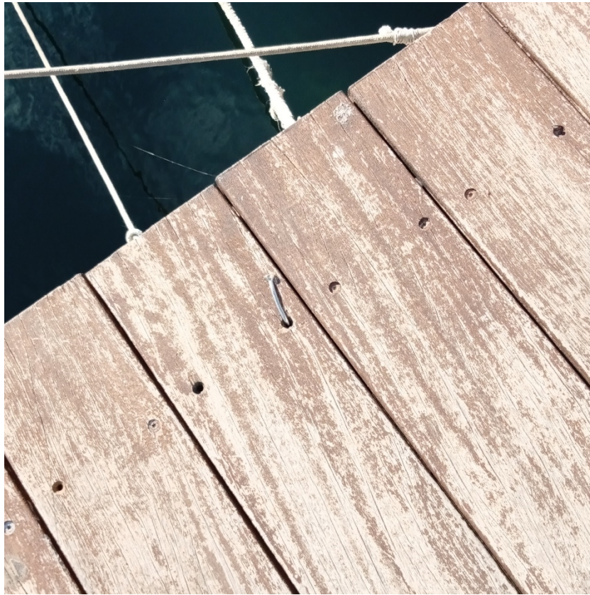
Fotografia 9. Falta de cargols i intents de fixació no reeixits.
