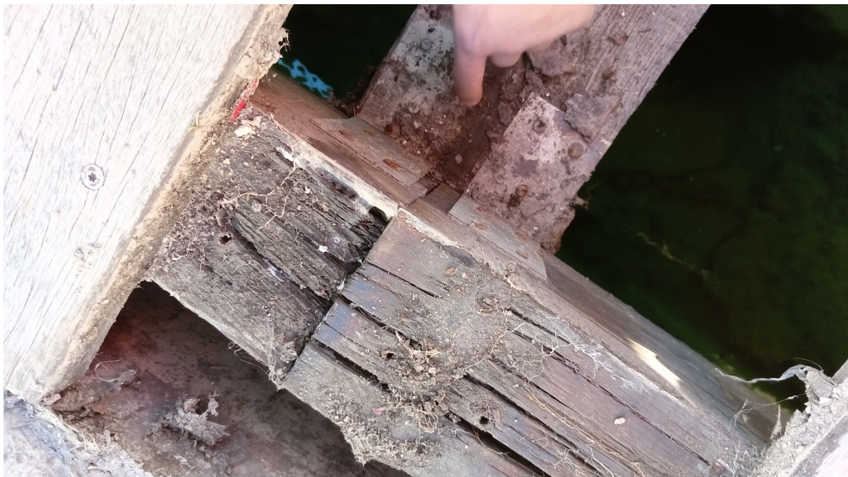
Fotografia 10. Aspecte de les bigues longitudinals. Extrems força malmesos per el pas del temps i acumulació de brutícia.
