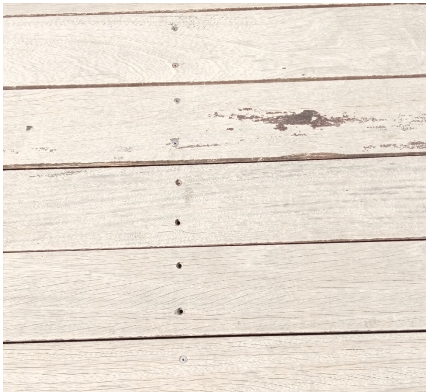
Fotografia 6. Desgast de la superfície pèrdua gairebé completa de la protecció superficial i manca de cargols.
