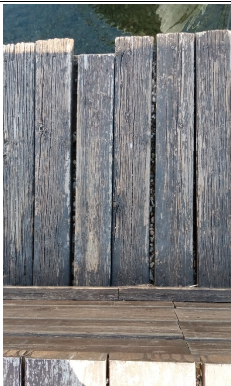
Fotografia 19. Degradació i desplaçament dels llistons, acumulació de terres i pedres.
