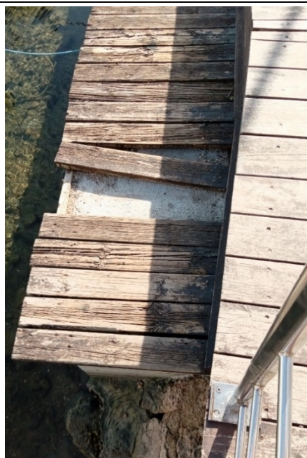
Zona 2. Paviment de fusta del nivell inferior completament deteriorat
