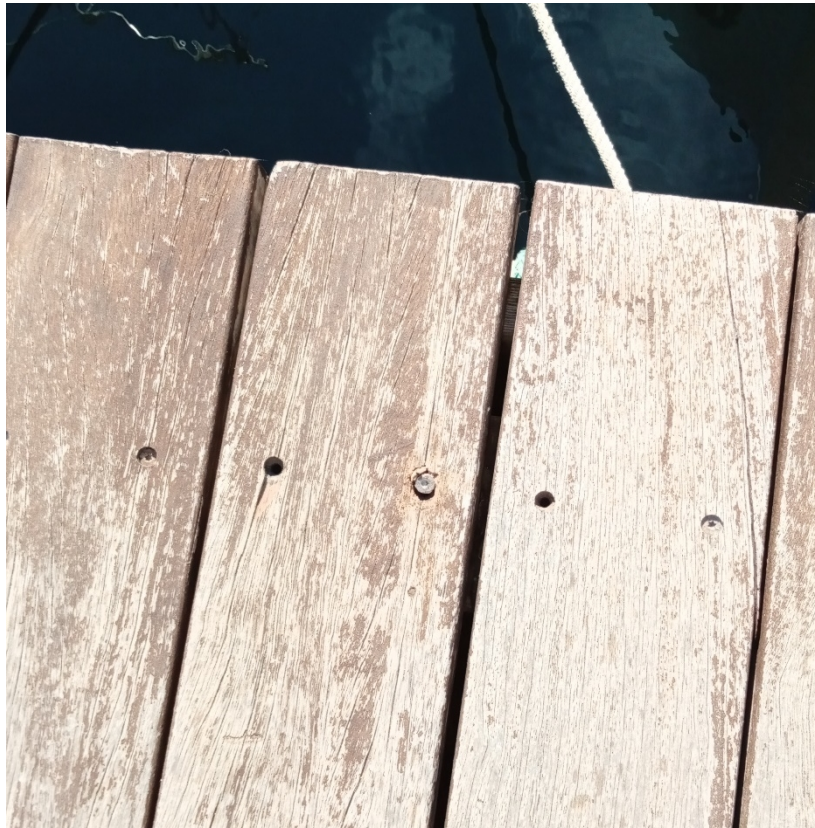
Fotografia 7. Pèrdua de la capa superficial i falta de cargols.
