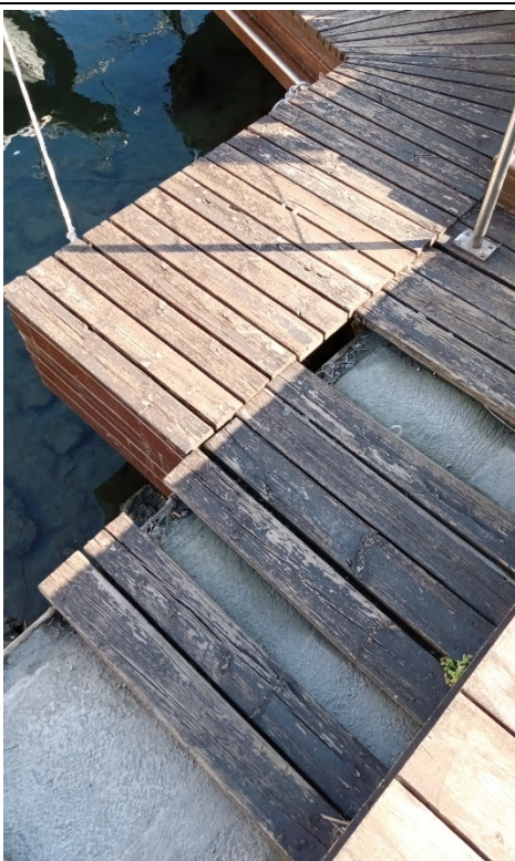
Fotografia 20. Pèrdua considerable de llistons i desplaçament dels mateixos.
