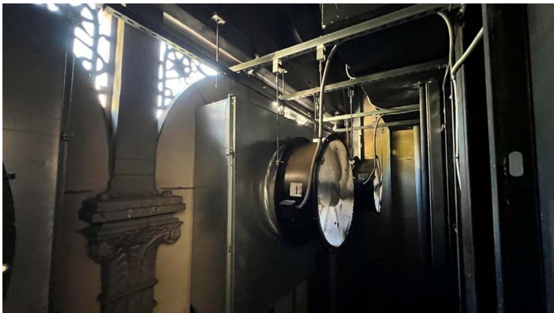
Imatge 4. Ventiladors helicoidals de façana
