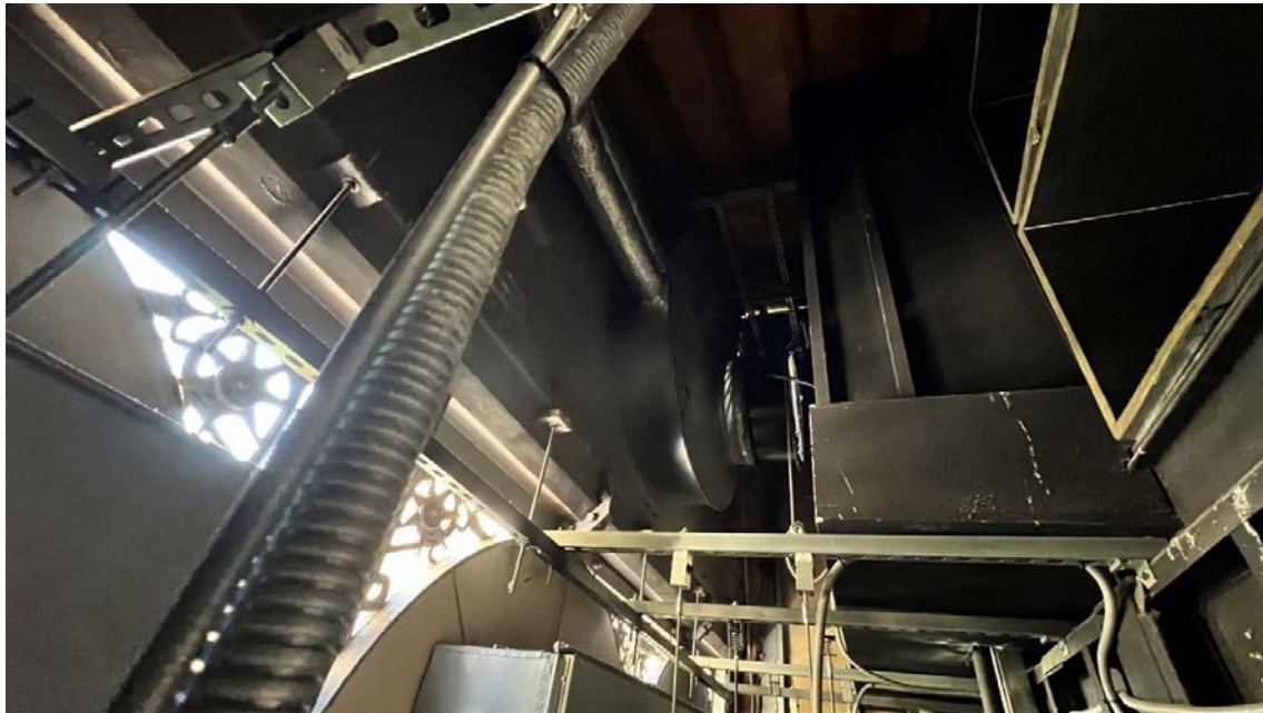
Imatge 5. Espai intermedi on s'aprecien els ventiladors i la sortida d'aire d'una aerotèrmia.
