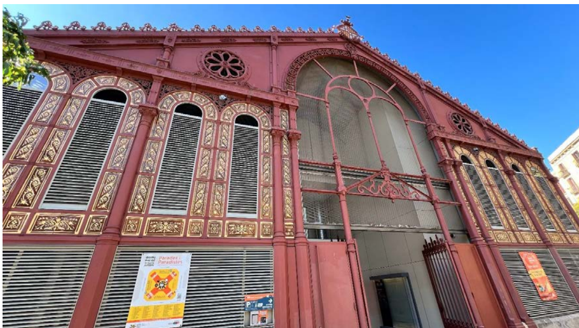
Imatge 1. Façana de la cantonada amb dos unitats de climatització a cada costat
