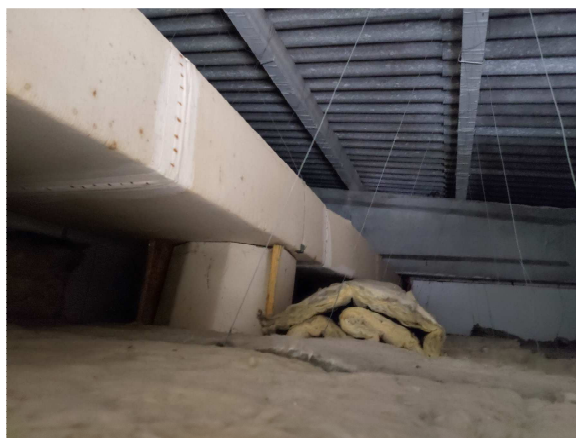
Detall conducte climatització i aïllament de llana de roca sobre el fals sostre
