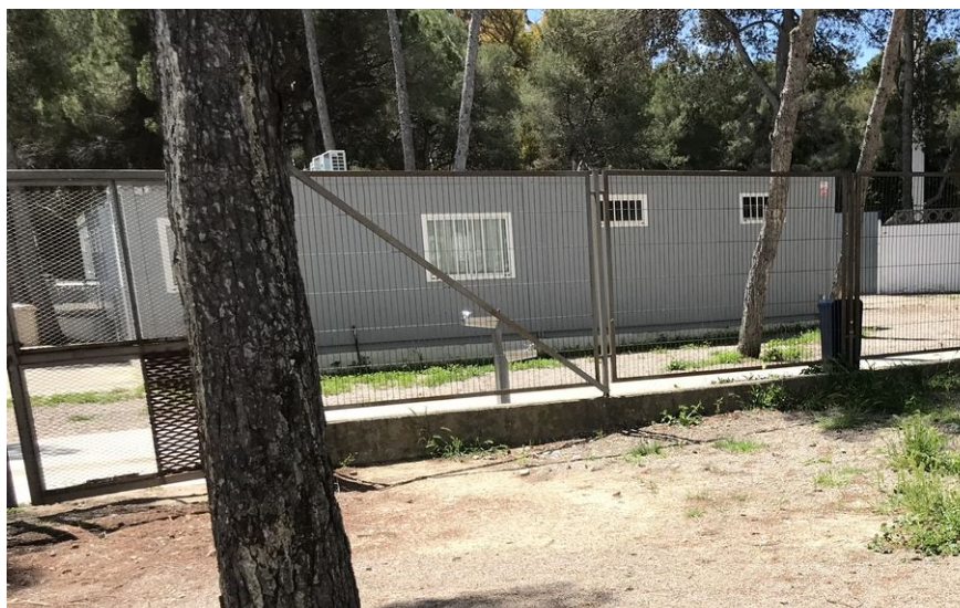
Imatge 8.- Exterior mòdul prefabricat oficines i magatzem
