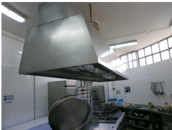
Campana Extractora de fums
